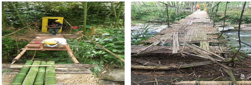
Fotografías 3-4. Detalle de tablero de piso y elementos estructurales deteriorados. Fuente: Contratista.
