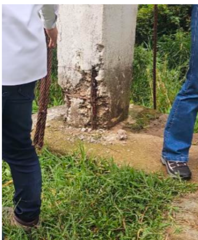
imagen 1/ Deterioro columnas torre de anclaje
