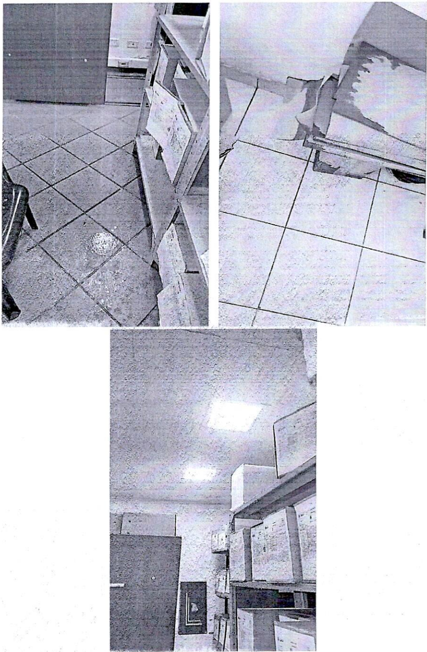
Imagen No. 8. Vista interior de la actual OFICINA DE ARCHIVO CENTRAL DEL MUNICIPIO DE SAN GIL, SANTANDER en tiempos de lluvia”.
