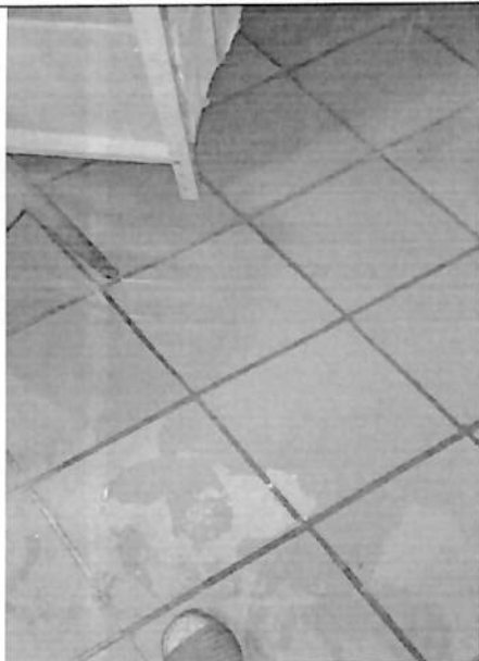
Se observan charcos y huellas húmedas, lo que indica filtraciones activas dentro del área de archivo. Esto confirma que el agua está ingresando directamente al espacio, afectando las condiciones ambientales y de conservación.
