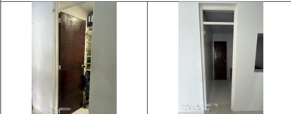
Baño de toma de CCU
