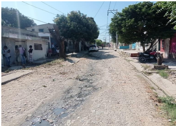
Foto No. 1 - Situación Actual vertimiento de aguas residuales en las calles.
