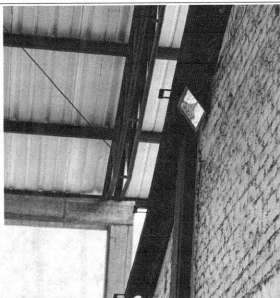
Ilustración 26 Suministro e instalación reflector led 200w
