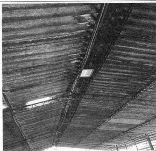
Ilustración 28 Suministro e instalación reflector led 200w
