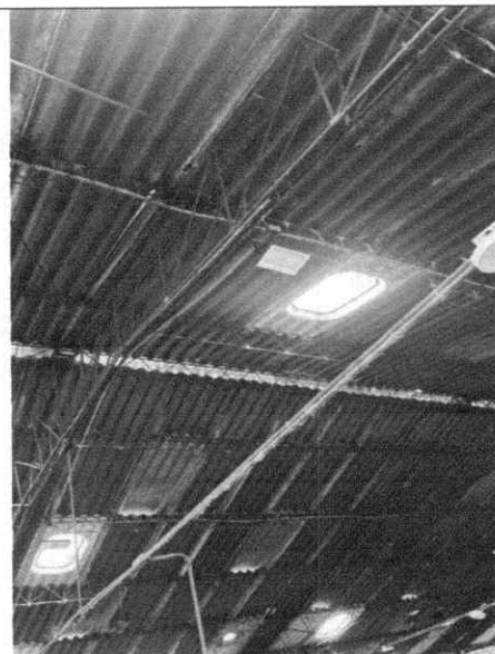
Ilustración 27 Suministro e instalación reflector led 200w
