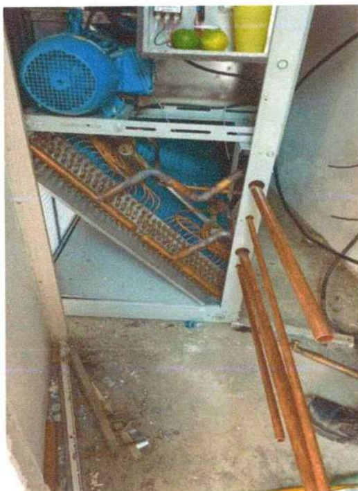
Figura 8- Página 32- Componentes internos y materiales de refrigeración instalados.
