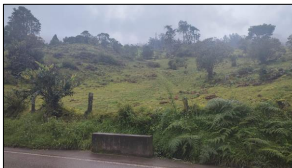
FOTOGRAFÍA NO. 1 VISTA TALUD SUPERIOR Y PROCESOS DE REPTACIÓN ODT-NN15 POTRERITOS
