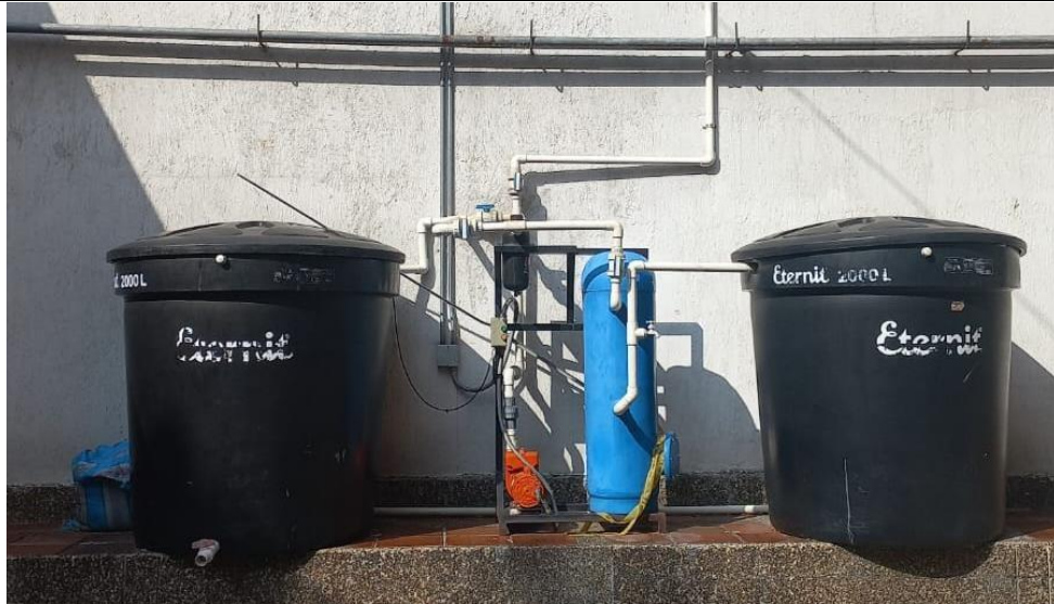
TANQUE DE CABINA DE PINTURA
