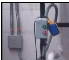
ARRANCADOR Y FLOTADOR DE CONTROL DE LA BOMBA CENTRÍFUGA.
