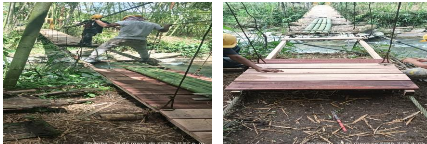
Fotografías 1-2. Vista general del puente en estado inicial de deterioro. Fuente: Contratista.
