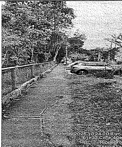
Anden en mal estado.
