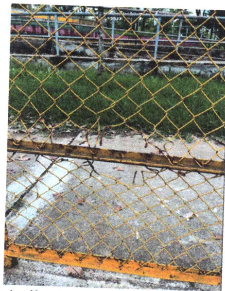
Ilustración 14. Malla destemplada y deteriorada
