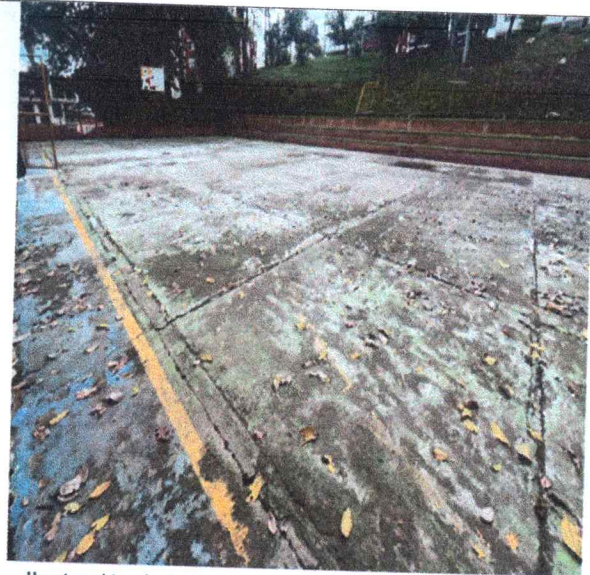
Ilustración 4. falta reparación de placa y pintura de cancha
