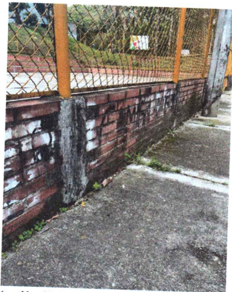
Ilustración 13. Mampostería de cerramiento en mal estado con presencia de humedad
