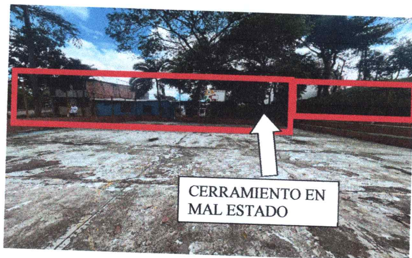
Ilustración 12. Cerramiento en mampostería y malla eslabonada en mal estado
