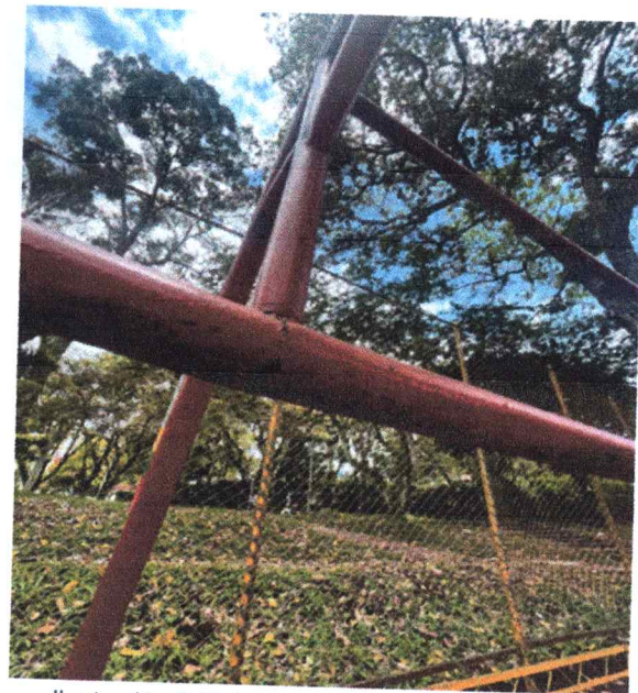
Ilustración 6 Mal estado de los arcos oxido y deterioro
