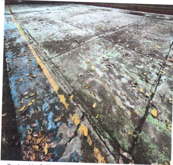
Ilustración 3. Presencia de grietas y falta de sello en dilataciones
