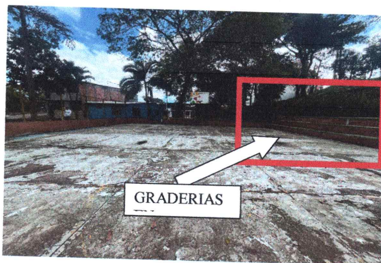
Ilustración 7. Graderías en mampostería en estado de deterioro
