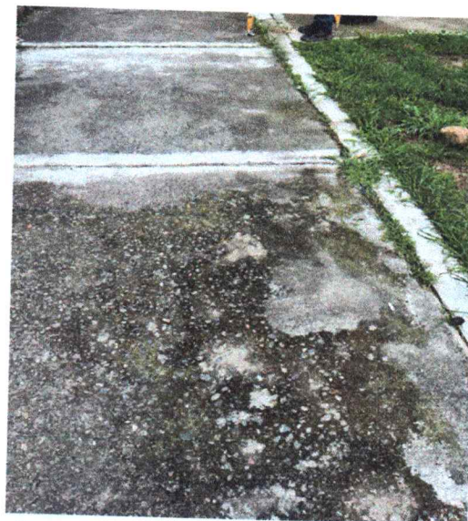
Ilustración 18. Andén con presencia de maleza y mal estado
