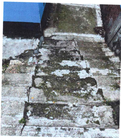
Ilustración 17. Escaleras agrietadas y presencia de humedad
