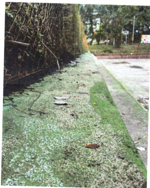
Ilustración 8. Mal estado de la placa de graderías
