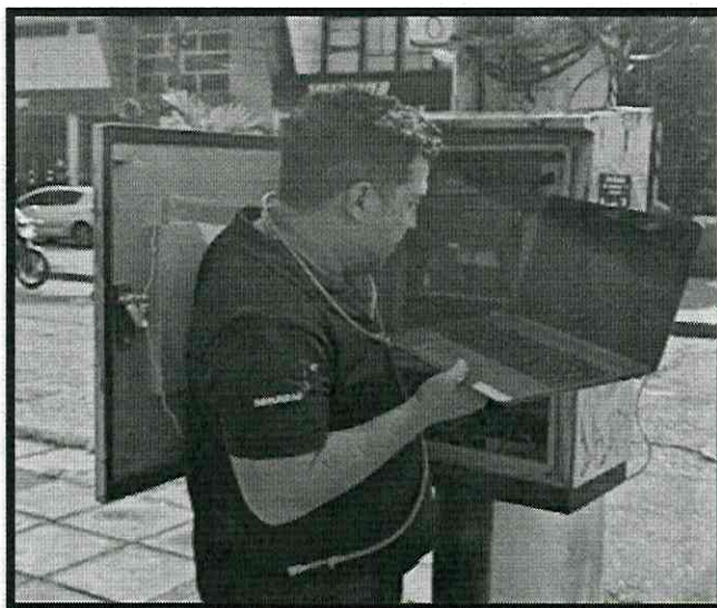
Imagen 20: Registro fotografico del mantenimiento preventivo pan del canasto Del 16 al 22 de marzo de marzo de 2026
