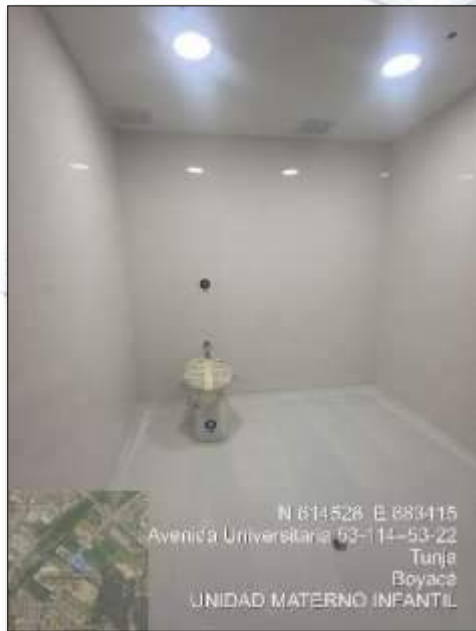
Imagen 55: Sanitario con válvula tipo push.
