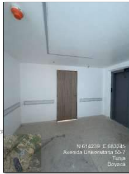
Imagen 44: Instalación de guarda camilla nivel 4
