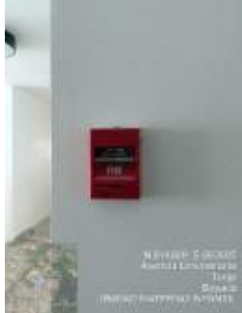
Imagen 9. Estación manual de alarma
