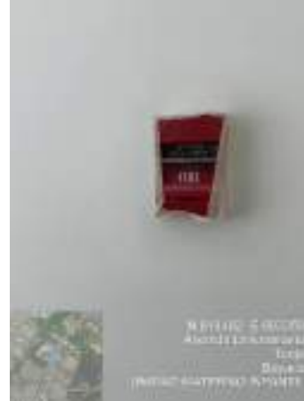
Imagen 10. Estación manual de alarma
