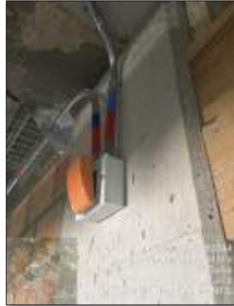
Imagen 12. Estación manual de alarma
