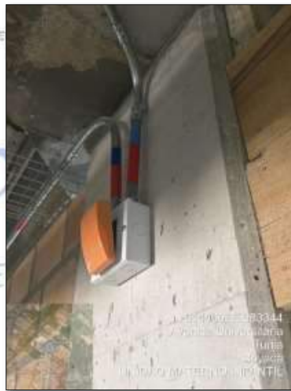
Imagen 46: Estación manual de alarma
