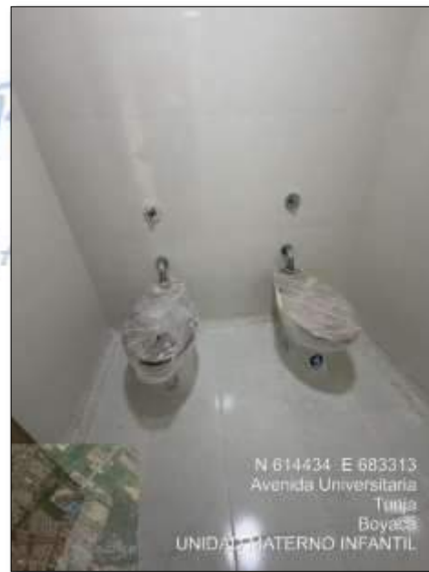
Imagen 56: Sanitario con válvula tipo push.
