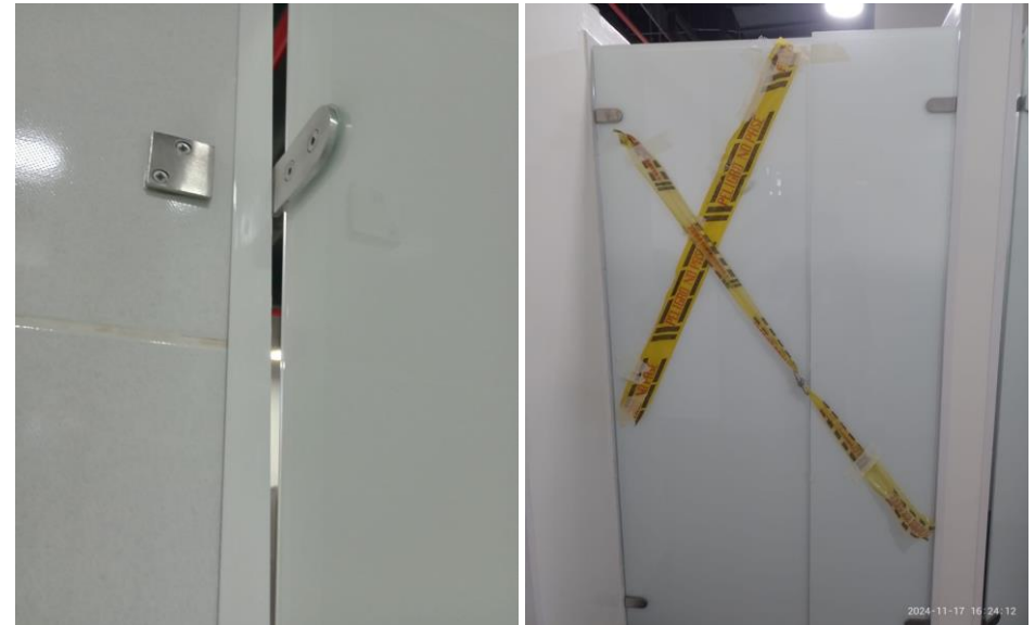
PUERTAS DE VIDRIO DESAJUSTADAS
