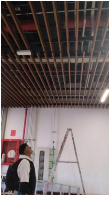
Seguimiento arreglo gotera lobby, daño en bateria de baños publicos
