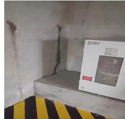
FILTRACIONES PISCINA RECREATIVA EN ZONA SUBTERRANEA
