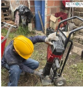
Ilustración 69 Inspección de Maquinaria
