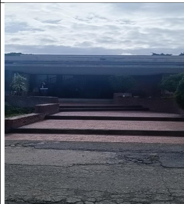
Fachada principal y acceso al edificio administrativo del SGC. Descascaramiento de la pintura en viga corona.
