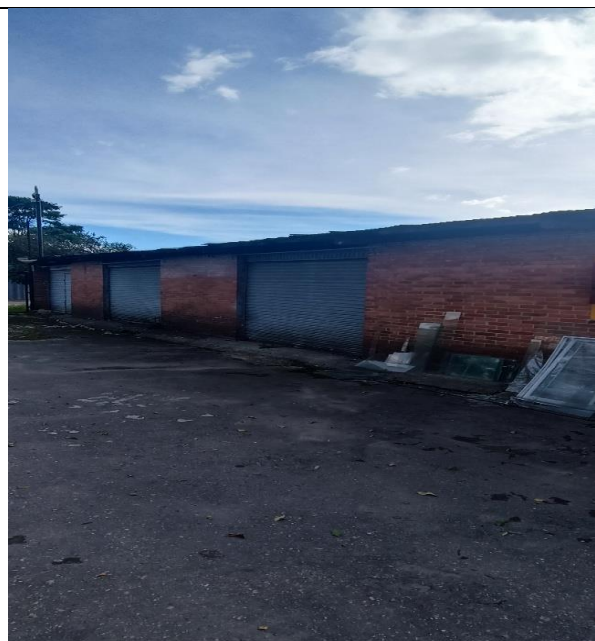
Fachada de muros de ladrillo a la vista que no han tenido actividades de mantenimiento en edificaciones destinadas a bodegas.
