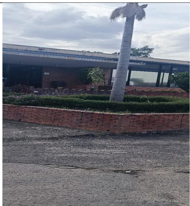
Muros en ladrillo a la vista descoloridos de jardineras en la parte frontal del acceso al edificio administrativo.
