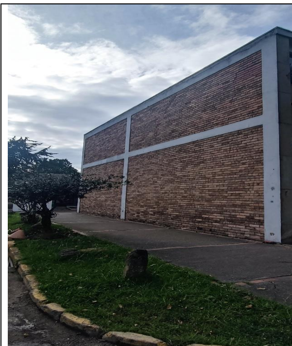
Fachada en ladrillo a la vista descolorido y con afectación estética por su elevado grado de suciedad.
