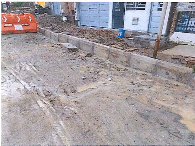
Evidencia de fuertes lluvias
