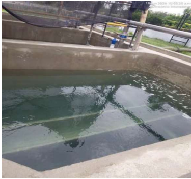
ESTADO ACTUAL MODULO DE FILTRACION B PTAP GUACARI EN SERVICIO
