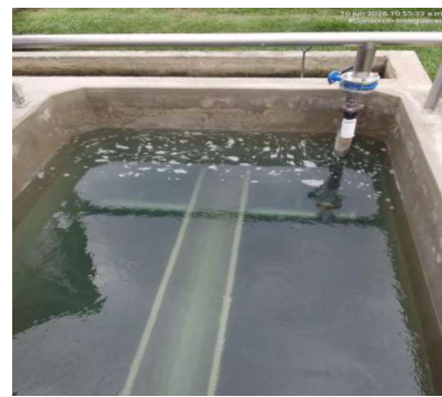
ESTADO ACTUAL MODULO DE FILTRACION B PTAP GUACARI EN SERVICIO
