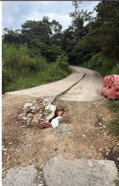
Desplazamiento de placas Tramo 3 K0+130
