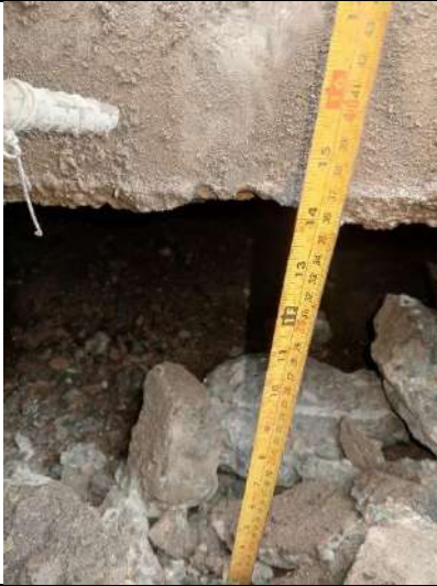
Desplazamiento de placas Tramo 2 K0+200
