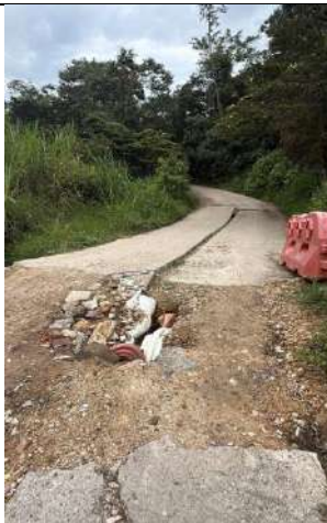
Desplazamiento de placas Tramo 3 K0+133
