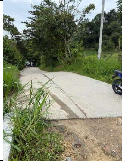
Desplazamiento de placas Tramo 2 K0+200
