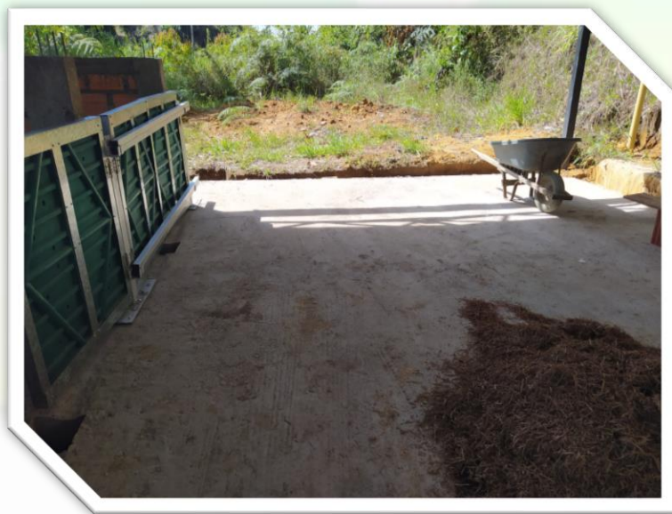
Espacio para la preparación de cama para recepción de orgánicos
