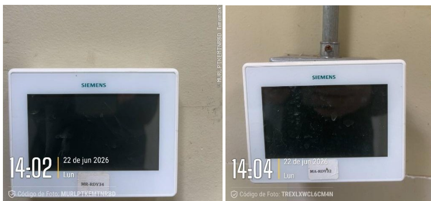
Foto 55. Fallas en pantallas de registro de temperatura
