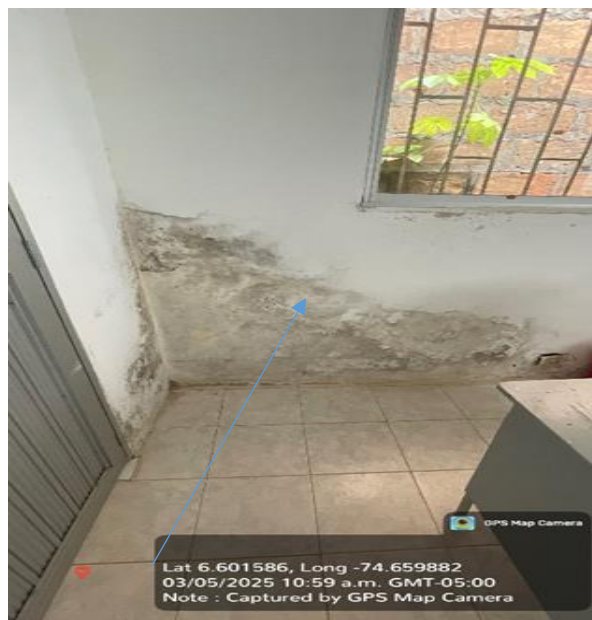
Foto 04: Detalle muros internos que presentan deterioro con hongos y afectación de revocos y pinturas.
