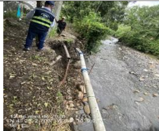
Foto 2. Tubería Acueducto Intermunicipal Expuesta
