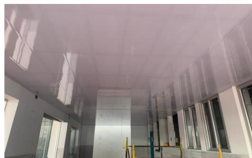
CIELO RASO EN PVC
