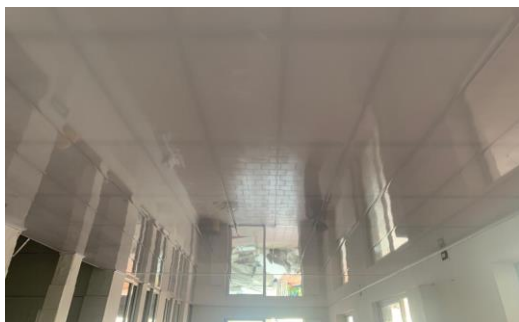
CIELO RASO EN PVC
