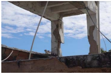
ESTRUCTURA TANQUES AEREOS
