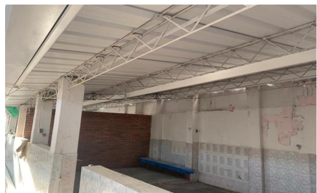
CANAL EN LAMINA GALVANIZADA CON ANTICORROSIVO Y PINTURA BLANCA
