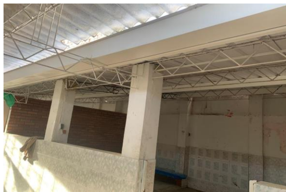
CANAL EN LAMINA GALVANIZADA CON ANTICORROSIVO Y PINTURA BLANCA
