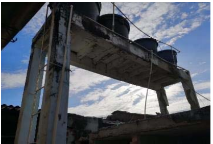
ESTRUCTURA TANQUES AEREOS
