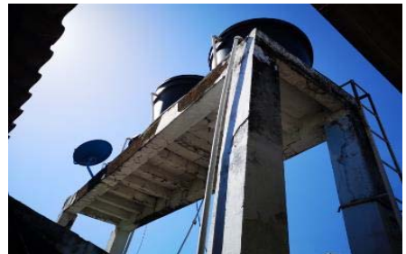
ESTRUCTURA TANQUES AEREOS
