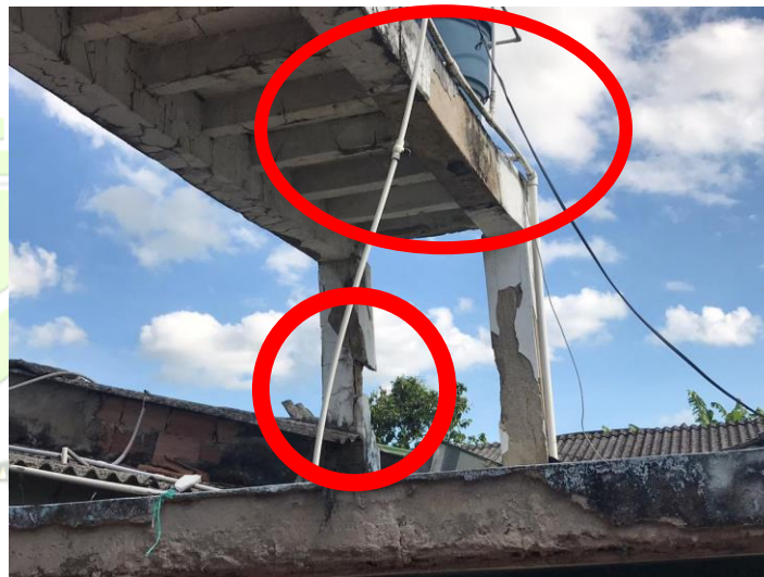
Imagen del estado de la estructura
