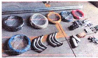
Fotografía 11 Cable THHN por colores, tubería, curvas y accesorios eléctricos
