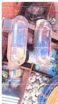
Fotografía 40 Conduletas de 1" con tapa
