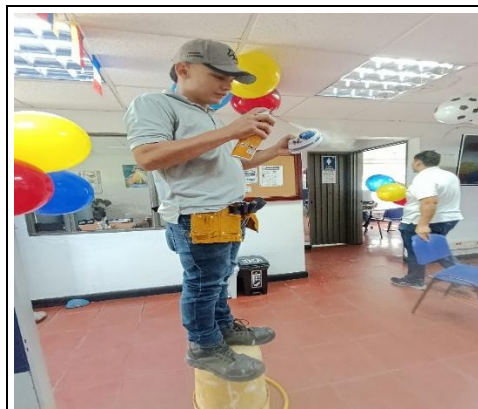
MANTENIMIENTO SENSORES DE HUMO
