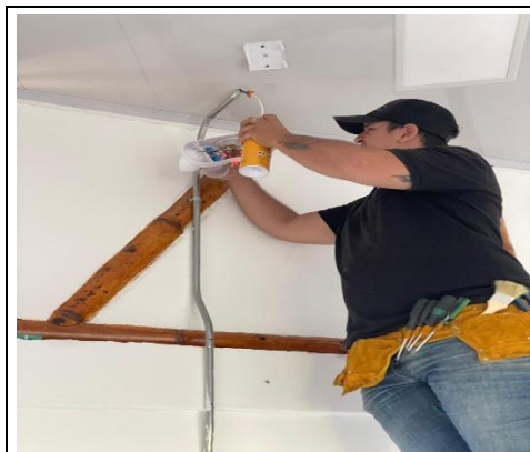
MANTENIMIENTO LAMPARAS DE EMERGENCIA
