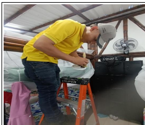
MANTENIMIENTO SENSORES DE HUMO
