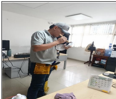
MANTENIMIENTO SENSORES DE HUMO
