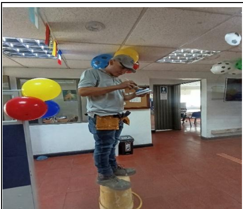
MANTENIMIENTO SENSORES DE HUMO
