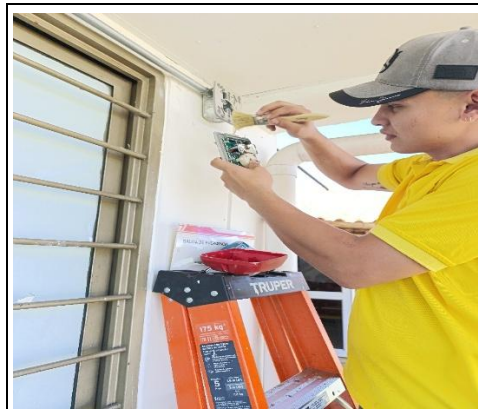
MANTENIMIENTO LUCES ESTROBOSCOPICAS
