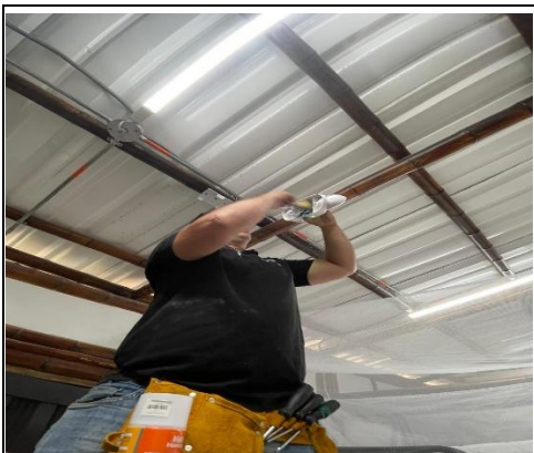
MANTENIMIENTO LAMPARAS DE EMERGENCIA
