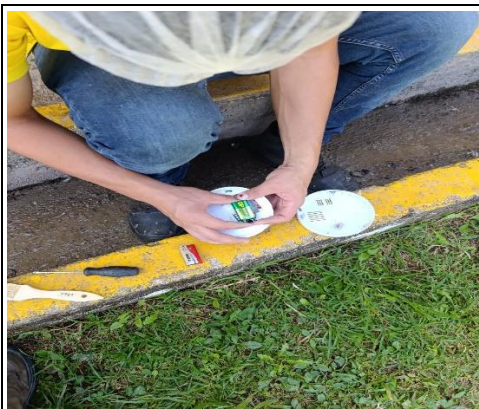
MANTENIMIENTO SENSORES DE HUMO
