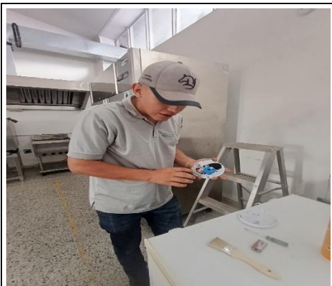
MANTENIMIENTO SENSORES DE HUMO
