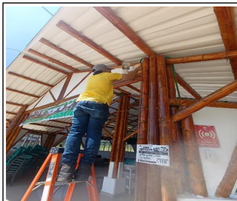
MANTENIMIENTO ALARMAS DE EMERGENCIA
