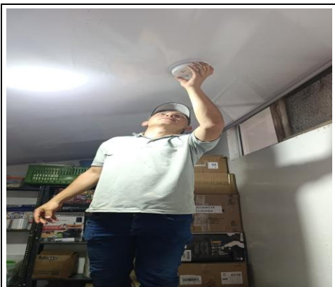
INSTALACION AMBIENTE PANADERIA
