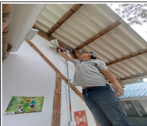
MANTENIMIENTO ALARMAS DE EMERGENCIA
