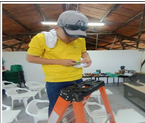
MANTENIMIENTO SENSORES DE HUMO
