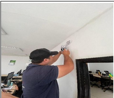
MANTENIMIENTO LAMPARAS DE EMERGENCIA
