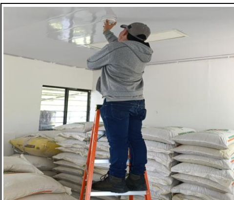
INSTALACION GRANJA AVICOLA
