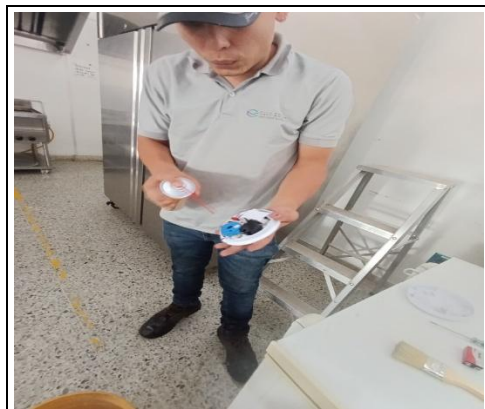
MANTENIMIENTO SENSORES DE HUMO
