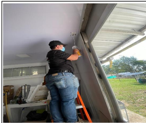
MANTENIMIENTO LAMPARAS DE EMERGENCIA
