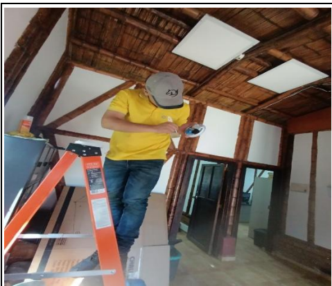
MANTENIMIENTO SENSORES DE HUMO
