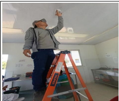
INSTALACION GRANJA AVICOLA
