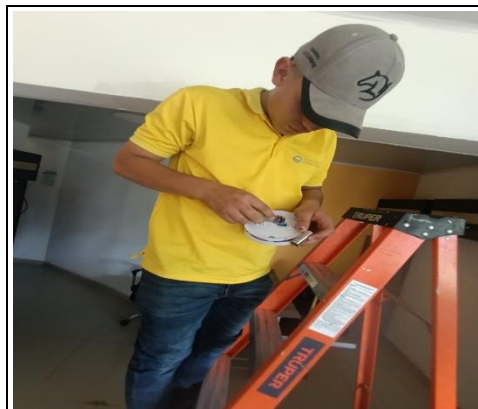
MANTENIMIENTO SENSORES DE HUMO
