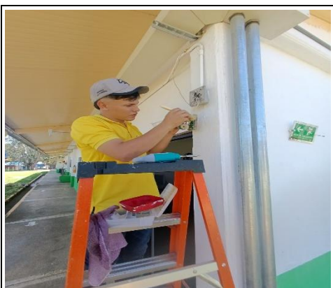
MANTENIMIENTO LUCES ESTROBOSCOPICAS
