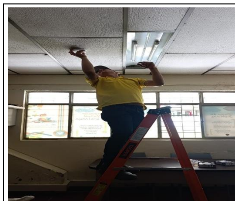
INSTALACION AMBIENTE PROYECTOS
