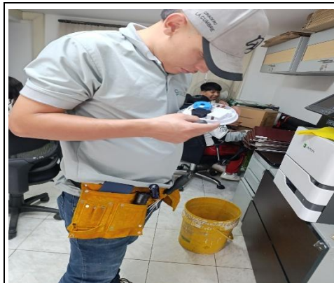
MANTENIMIENTO SENSORES DE HUMO
