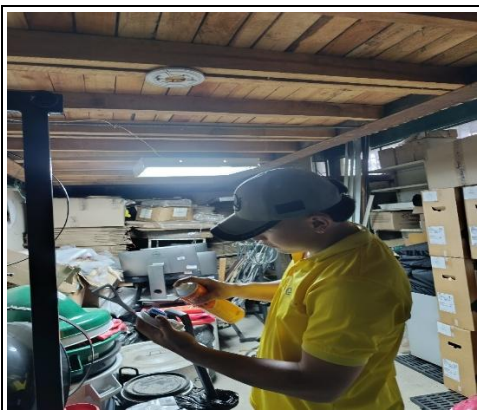
MANTENIMIENTO SENSORES DE HUMO
