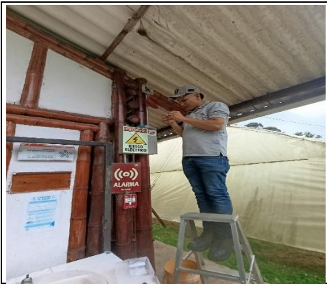
MANTENIMIENTO LUCES ESTROBOSCOPICAS
