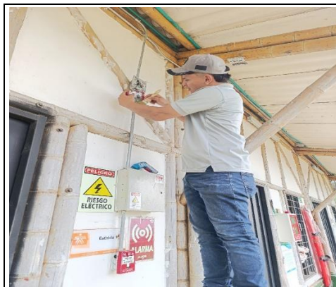
MANTENIMIENTO LUCES ESTROBOSCOPICAS
