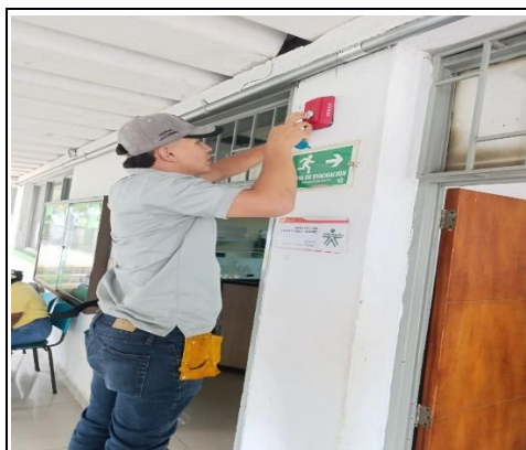
MANTENIMIENTO LUCES ESTROBOSCOPICAS
