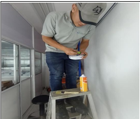
MANTENIMIENTO SENSORES DE HUMO
