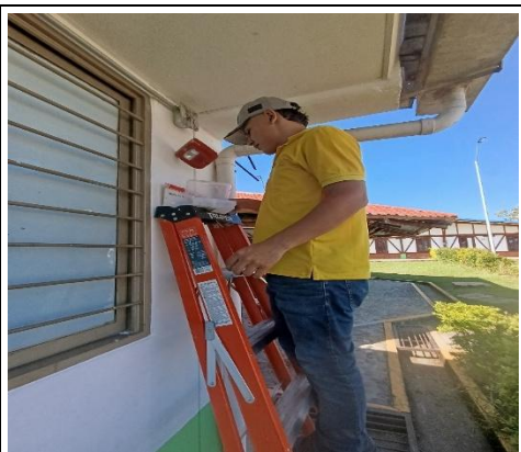
MANTENIMIENTO LUCES ESTROBOSCOPICAS
