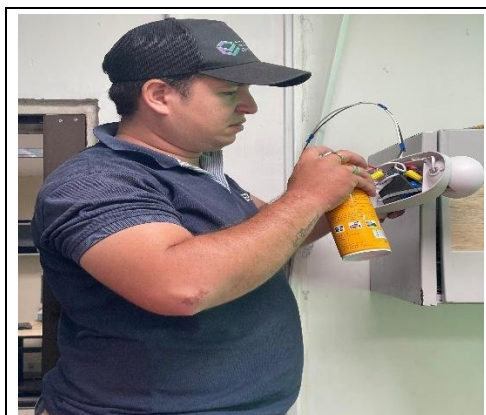
MANTENIMIENTO LAMPARAS DE EMERGENCIA
