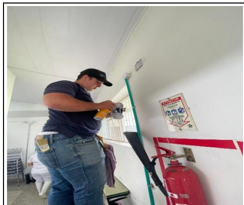
MANTENIMIENTO LAMPARAS DE EMERGENCIA
