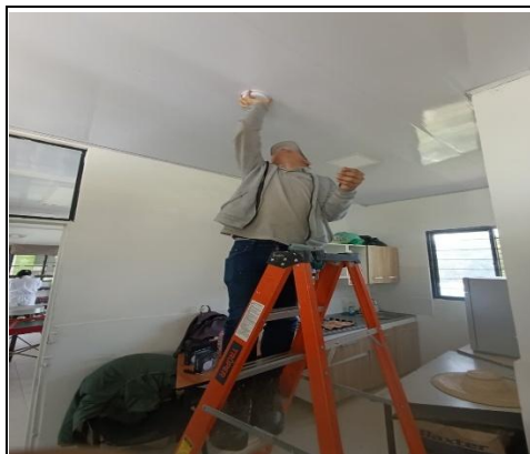
INSTALACION GRANJA AVICOLA
