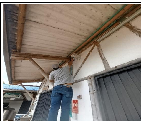
MANTENIMIENTO ALARMAS DE EMERGENCIA
