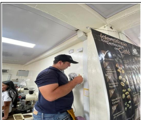
MANTENIMIENTO LAMPARAS DE EMERGENCIA
