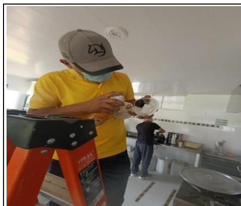
MANTENIMIENTO SENSORES DE HUMO
