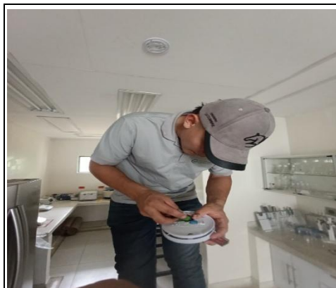
MANTENIMIENTO SENSORES DE HUMO
