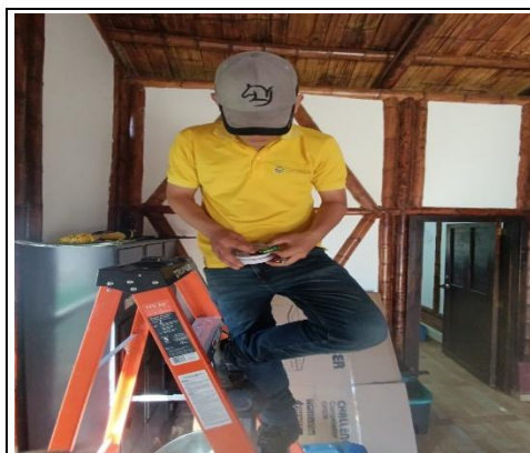
MANTENIMIENTO SENSORES DE HUMO
