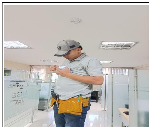
MANTENIMIENTO SENSORES DE HUMO
