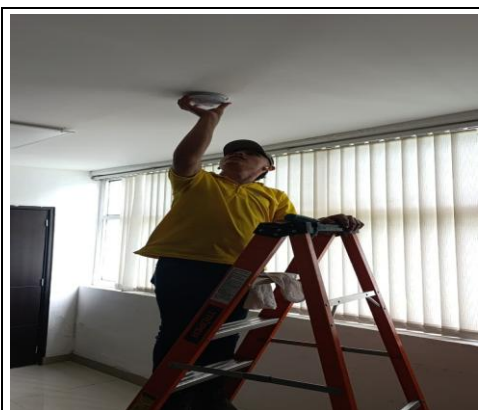
INSTALACION SUBDIRECCION AGRO
