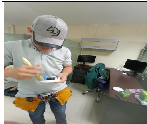
MANTENIMIENTO SENSORES DE HUMO
