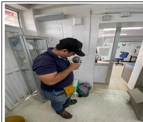
MANTENIMIENTO LAMPARAS DE EMERGENCIA
