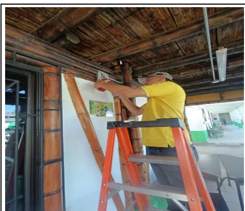
MANTENIMIENTO LUCES ESTROBOSCOPICAS
