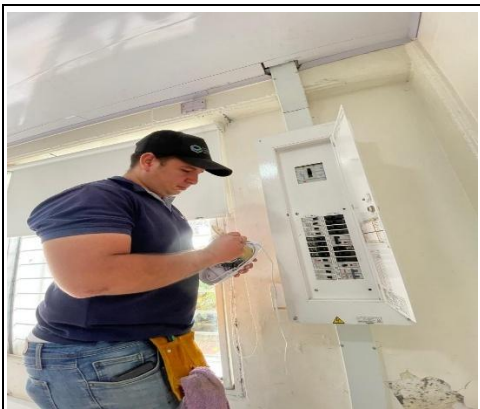
MANTENIMIENTO LAMPARAS DE EMERGENCIA
