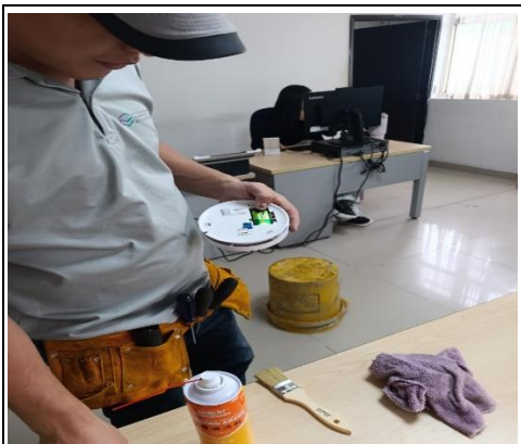
MANTENIMIENTO SENSORES DE HUMO
