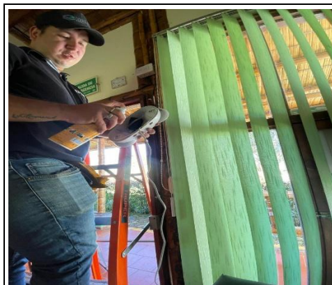
MANTENIMIENTO LAMPARAS DE EMERGENCIA
