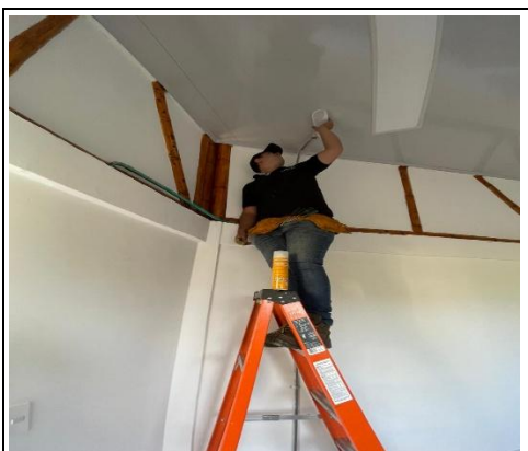
MANTENIMIENTO LAMPARAS DE EMERGENCIA
