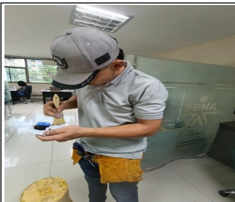
MANTENIMIENTO SENSORES DE HUMO
