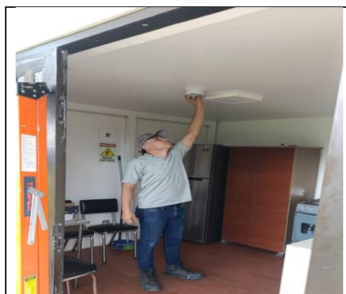
INSTALACION COCINA AGROPECUARIA
