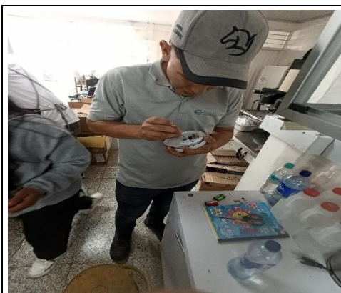
MANTENIMIENTO SENSORES DE HUMO
