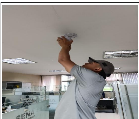
MANTENIMIENTO SENSORES DE HUMO
