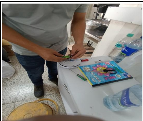
MANTENIMIENTO SENSORES DE HUMO
