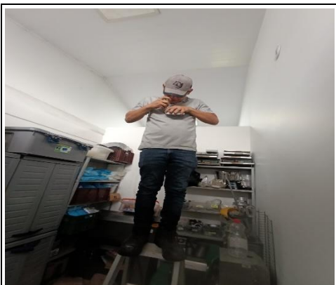
MANTENIMIENTO SENSORES DE HUMO
