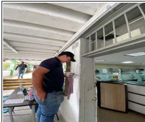
MANTENIMIENTO LAMPARAS DE EMERGENCIA
