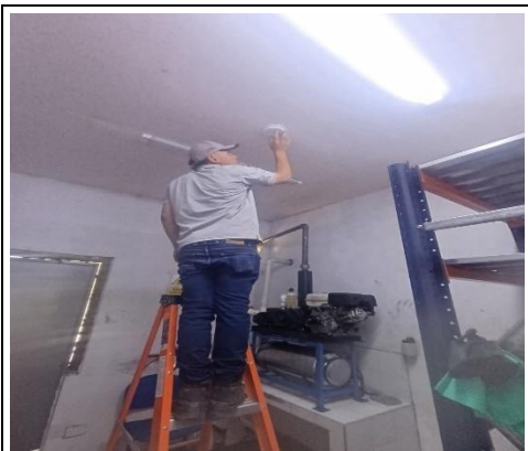
INSTALACION AREA GANADERIA TANQUE FRIO
