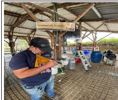
MANTENIMIENTO LAMPARAS DE EMERGENCIA
