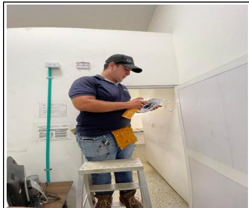
MANTENIMIENTO LAMPARAS DE EMERGENCIA
