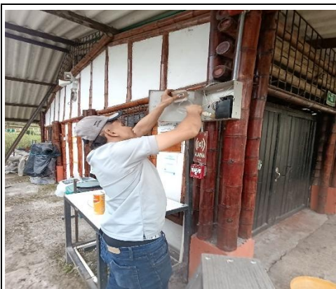
MANTENIMIENTO ALARMAS DE EMERGENCIA
