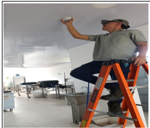
INSTALACION AMBIENTE PANADERIA
