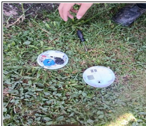
MANTENIMIENTO SENSORES DE HUMO
