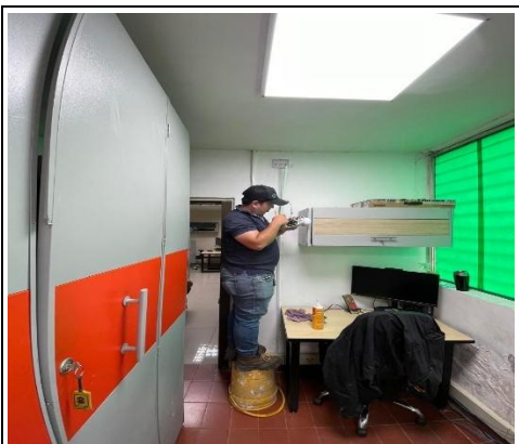
MANTENIMIENTO LAMPARAS DE EMERGENCIA
