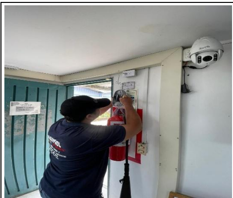
MANTENIMIENTO LAMPARAS DE EMERGENCIA
