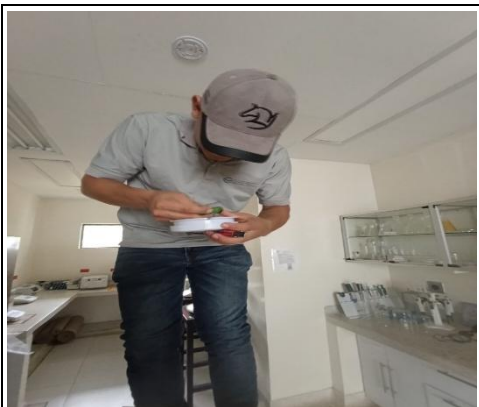
MANTENIMIENTO SENSORES DE HUMO
