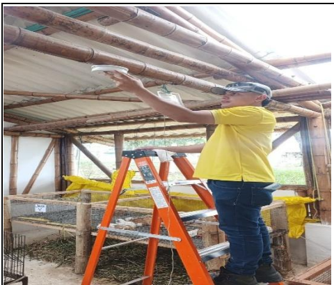
INSTALACION UNIDAD CUYICULA 2
