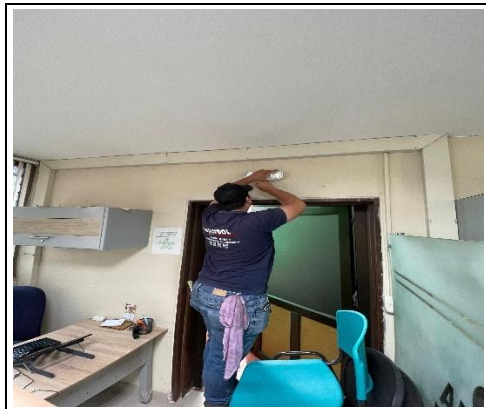
MANTENIMIENTO LAMPARAS DE EMERGENCIA
