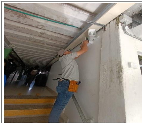
MANTENIMIENTO ALARMAS DE EMERGENCIA
