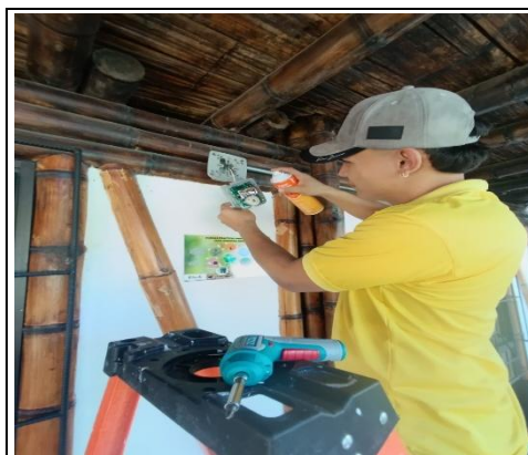
MANTENIMIENTO LUCES ESTROBOSCOPICAS
