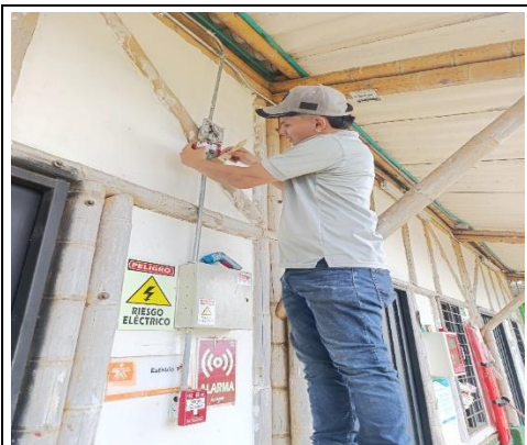
MANTENIMIENTO LUCES ESTROBOSCOPICAS
