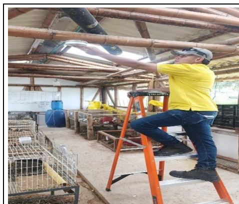
INSTALACION UNIDAD CUYICULA 2
