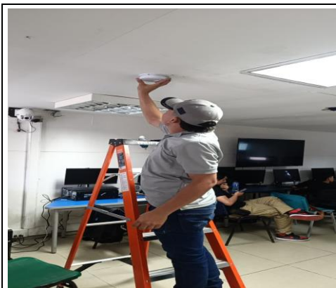
INSTALACION AMBIENTE TICS 2
