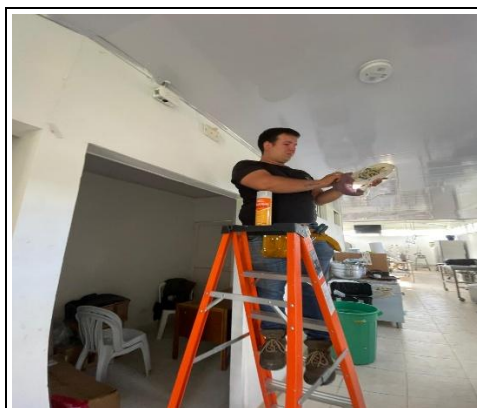
MANTENIMIENTO LAMPARAS DE EMERGENCIA
