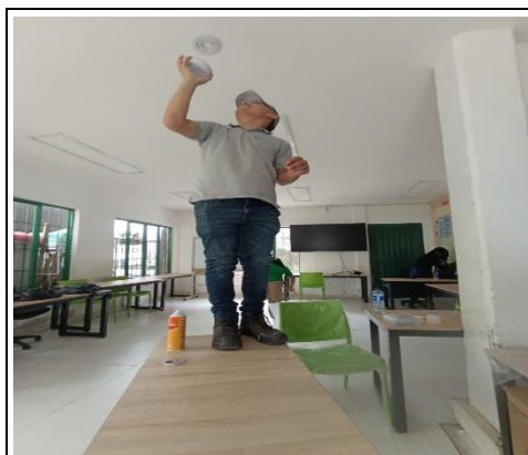
MANTENIMIENTO SENSORES DE HUMO
