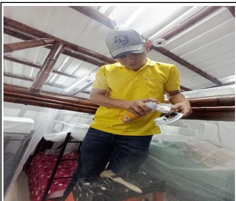
MANTENIMIENTO SENSORES DE HUMO
