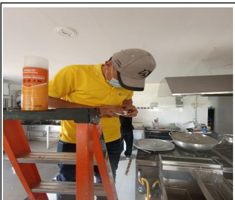
MANTENIMIENTO SENSORES DE HUMO
