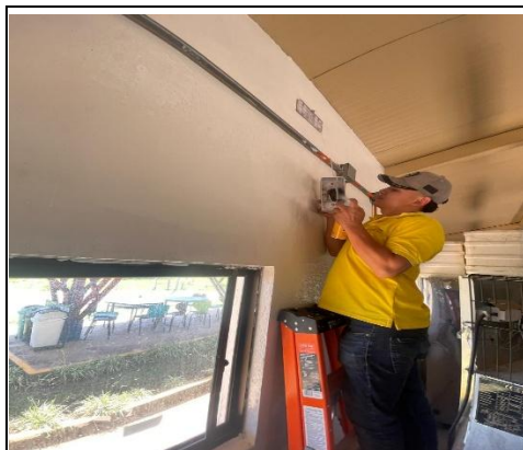
MANTENIMIENTO LAMPARAS DE EMERGENCIA
