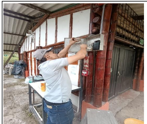
MANTENIMIENTO LUCES ESTROBOSCOPICAS
