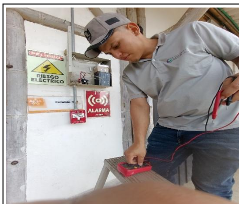
MANTENIMIENTO ALARMAS DE EMERGENCIA
