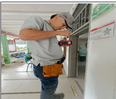
MANTENIMIENTO LUCES ESTROBOSCOPICAS
