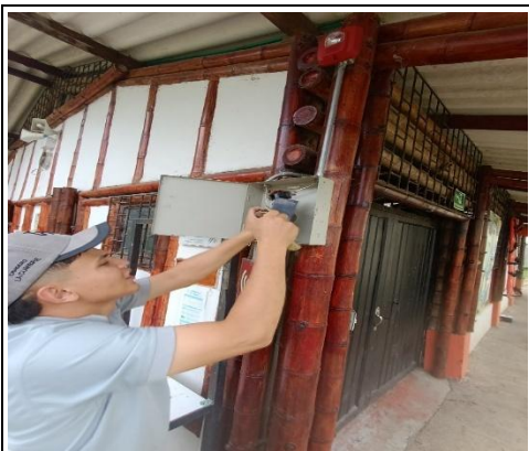
MANTENIMIENTO ALARMAS DE EMERGENCIA
