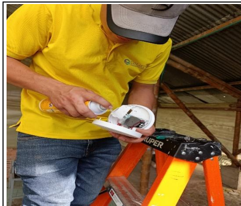
MANTENIMIENTO SENSORES DE HUMO
