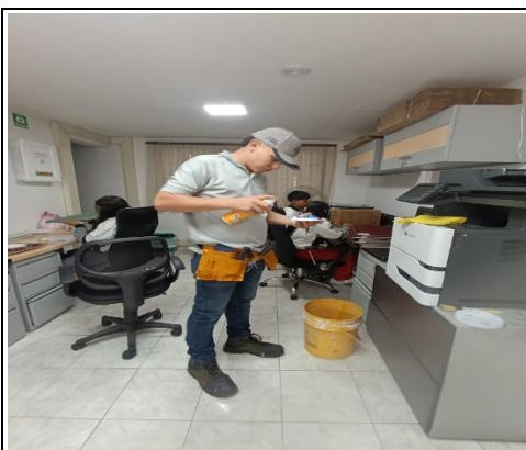
MANTENIMIENTO SENSORES DE HUMO
