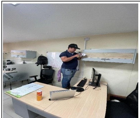
MANTENIMIENTO LAMPARAS DE EMERGENCIA
