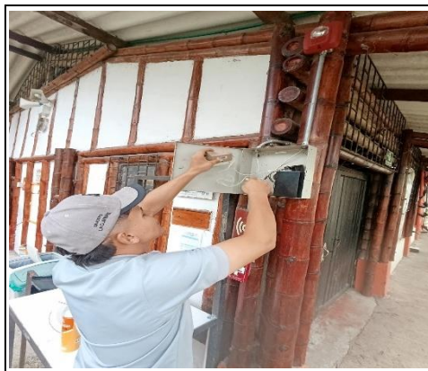
MANTENIMIENTO ALARMAS DE EMERGENCIA
