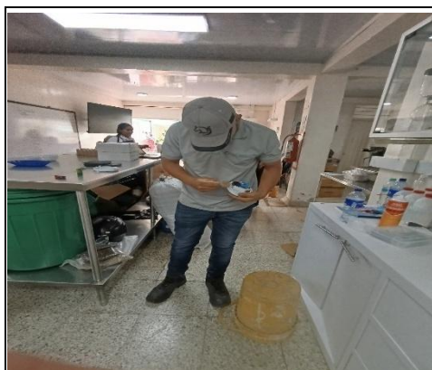
MANTENIMIENTO SENSORES DE HUMO
