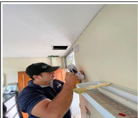
MANTENIMIENTO LAMPARAS DE EMERGENCIA
