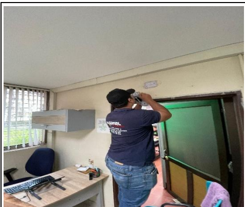
MANTENIMIENTO LAMPARAS DE EMERGENCIA
