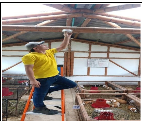
INSTALACION UNIDAD CUYICULA
