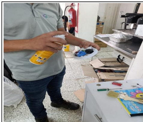
MANTENIMIENTO SENSORES DE HUMO
