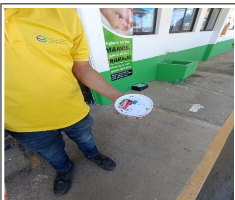
MANTENIMIENTO SENSORES DE HUMO
