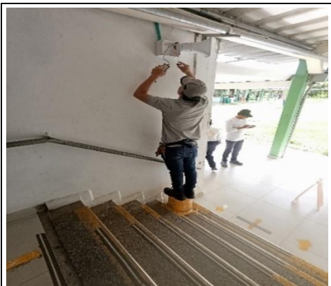
MANTENIMIENTO ALARMAS DE EMERGENCIA
