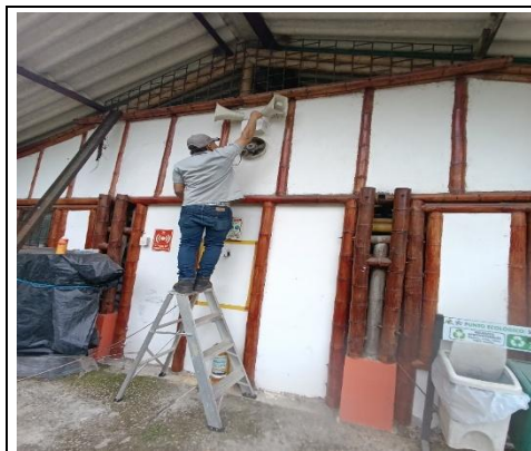
MANTENIMIENTO ALARMAS DE EMERGENCIA
