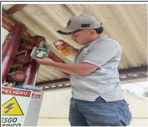
MANTENIMIENTO LUCES ESTROBOSCOPICAS
