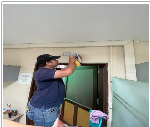
MANTENIMIENTO LAMPARAS DE EMERGENCIA
