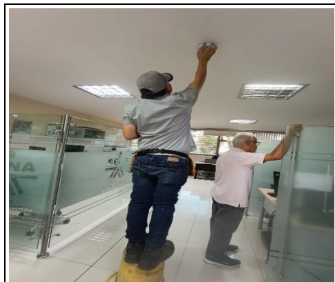
MANTENIMIENTO SENSORES DE HUMO
