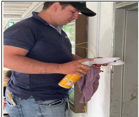
MANTENIMIENTO LAMPARAS DE EMERGENCIA
