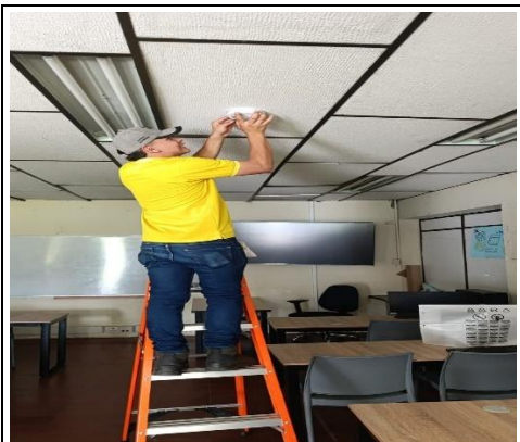
INSTALACION AMBIENTE PROYECTOS
