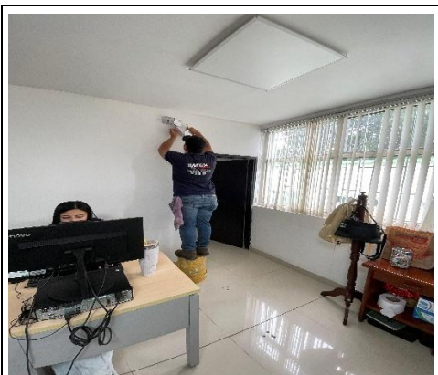
MANTENIMIENTO LAMPARAS DE EMERGENCIA
