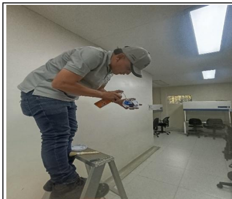
MANTENIMIENTO SENSORES DE HUMO
