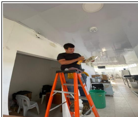
MANTENIMIENTO LAMPARAS DE EMERGENCIA
