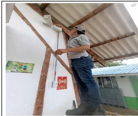
MANTENIMIENTO ALARMAS DE EMERGENCIA
