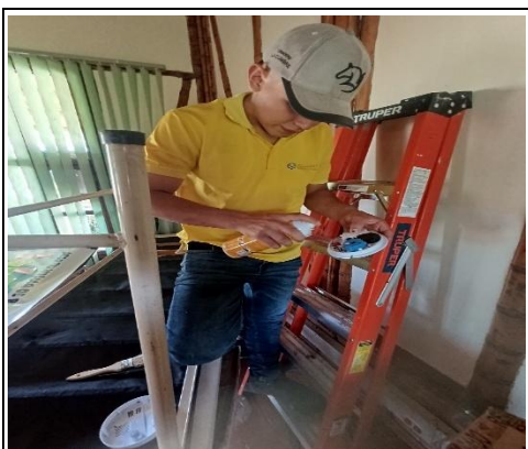
MANTENIMIENTO SENSORES DE HUMO
