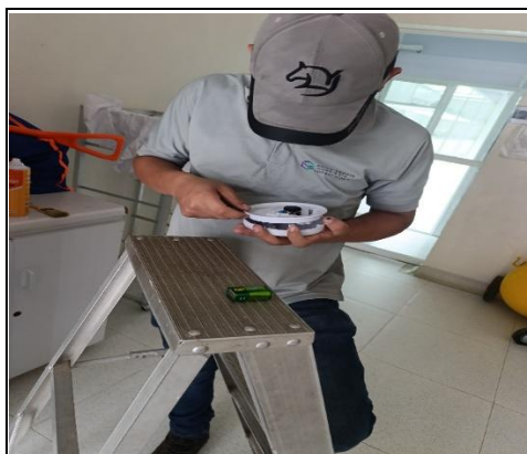
MANTENIMIENTO SENSORES DE HUMO
