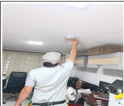
MANTENIMIENTO SENSORES DE HUMO
