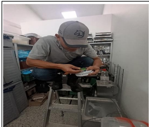
MANTENIMIENTO SENSORES DE HUMO
