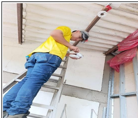
MANTENIMIENTO SENSORES DE HUMO
