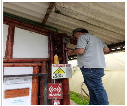
MANTENIMIENTO LUCES ESTROBOSCOPICAS
