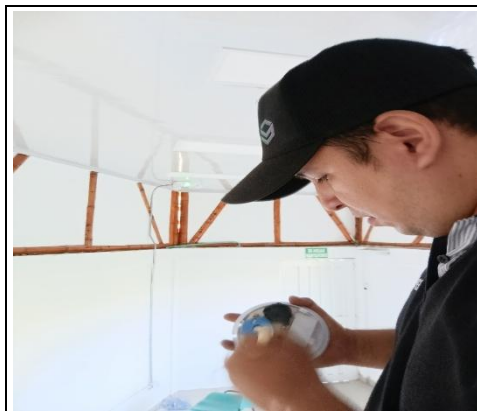
MANTENIMIENTO SENSORES DE HUMO
