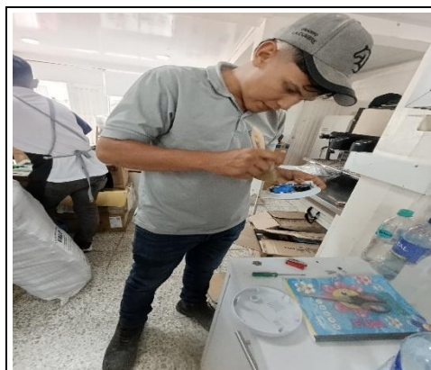
MANTENIMIENTO SENSORES DE HUMO
