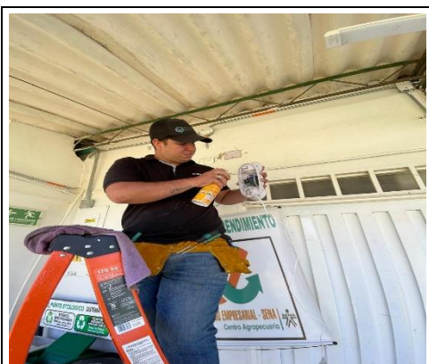
MANTENIMIENTO LAMPARAS DE EMERGENCIA
