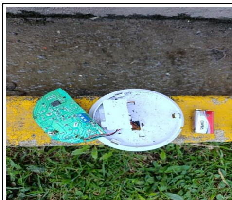
MANTENIMIENTO SENSORES DE HUMO
