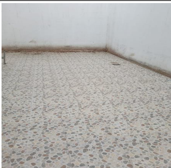
Foto No 28 muestra el deterioro de los pisos del jardín interior por causa de los excrementos de paloma
