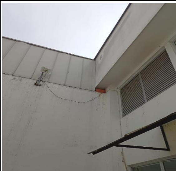
Foto No 29 estado de las paredes del jardín interior a causa de los excrementos de paloma.
