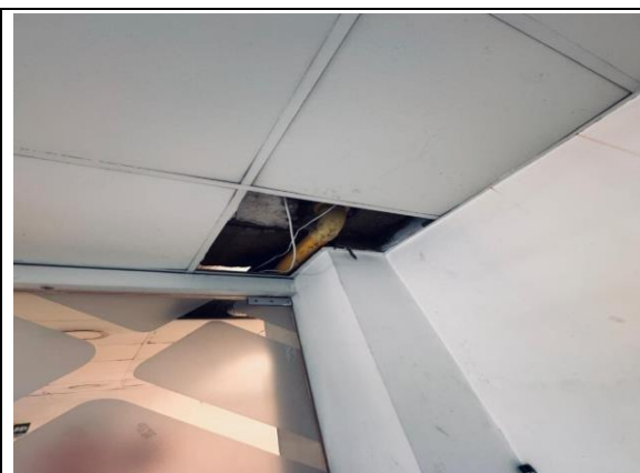
Foto No 27 panel de driwall faltante en el techo del piso 3 en la sala de capacitación
