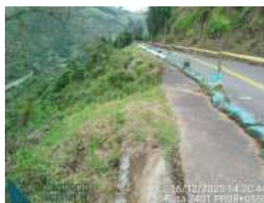
PR08+0550 pérdida parcial de banca. Deslizamiento rotacional, talud inferior inestable.
