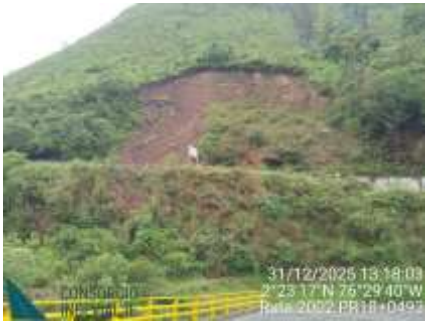
PR18+0493 deslizamiento rotacional en el talud superior. Sitio crítico que aún no ha sido atendido por el contratista de mantenimiento N°1006-2021
