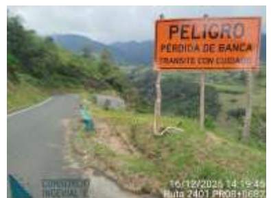
PR08+0687, pérdida parcial de banca. Deslizamiento rotacional, talud inferior inestable.
