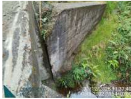
PR54+0280, socavación en aleta de pontón. Sitio que debe ser atendido.
