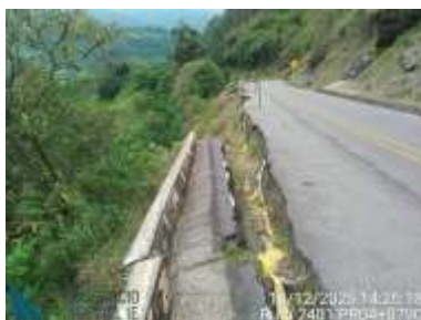
PR04+0790 pérdida parcial de banca. Deslizamiento rotacional, talud inferior inestable.
