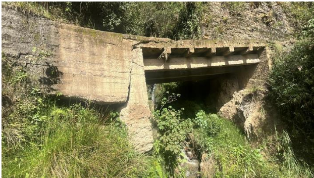
Imagen 1 – Puente vehicular afectado
