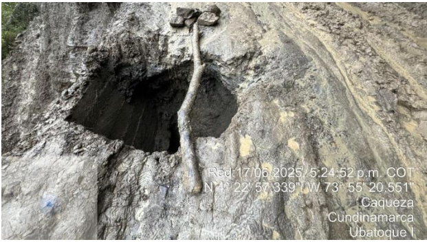
Imagen 2 – Socavación del puente
