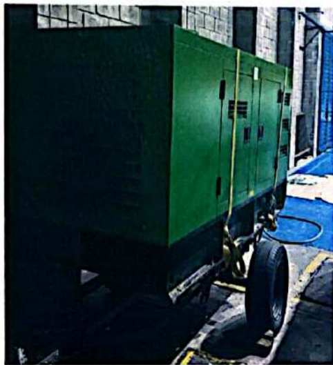
Lugar: Coliseo Carlos Alberto Bejarano Descripción: Planta Eléctrica
