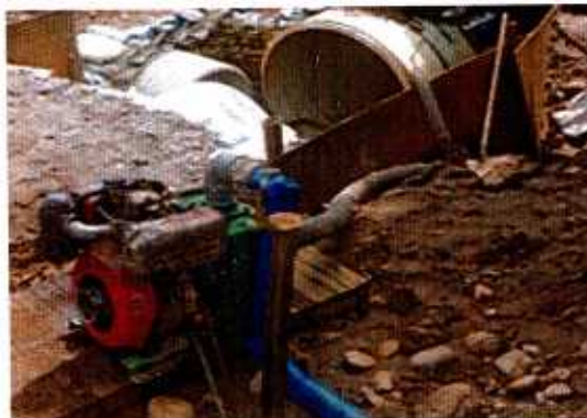
IMAGEN 12. MANEJO, CONTROL Y EXTRACCIÓN DE AGUA.
