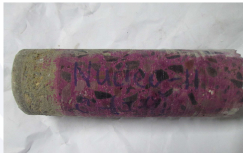
Imagen 9 Ejemplo de frente de carbonatación (zona sin color malva). Fuente: Propia
