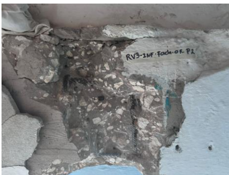
Imagen 24 Regata en viga de rigidez en cubierta de patio 3. Fuente: Propia
