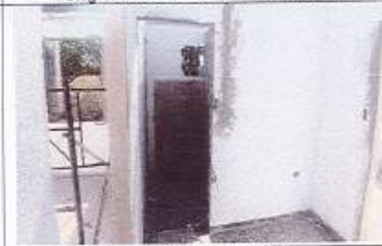
Fotografía No. 52 – Baño 3
