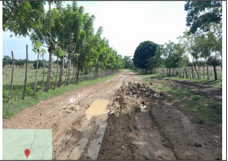
Estado actual de la vía en tramo 2.
