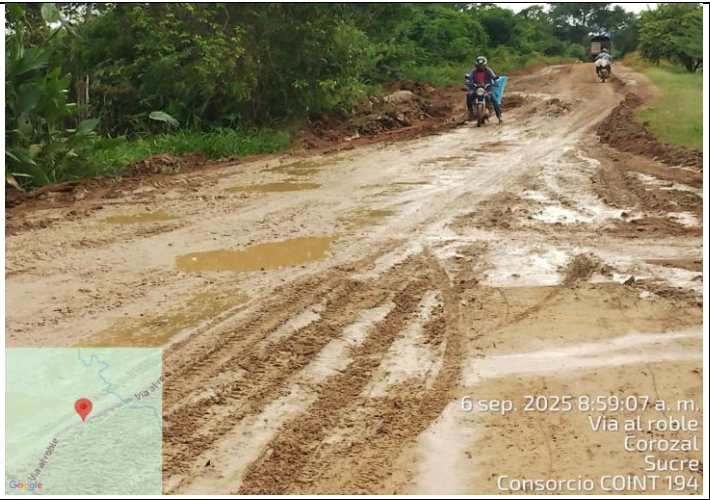
Estado inicial de la vía en el Tramo 1 del proyecto
