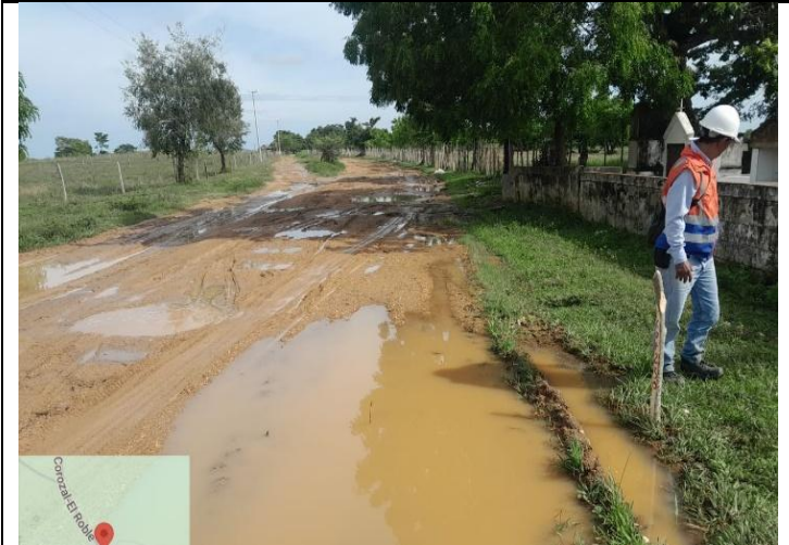
Estado actual de la vía en tramo 2.
