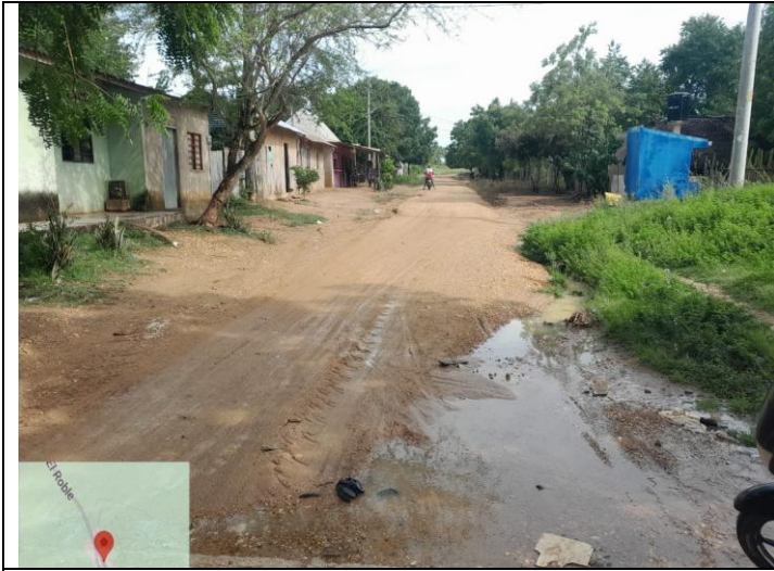
Estado actual de la vía en tramo 2.
