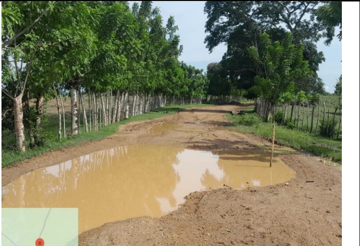
Estado actual de la vía en tramo 2.
