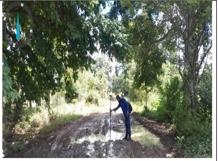
Estado actual de la vía en tramo 3.
