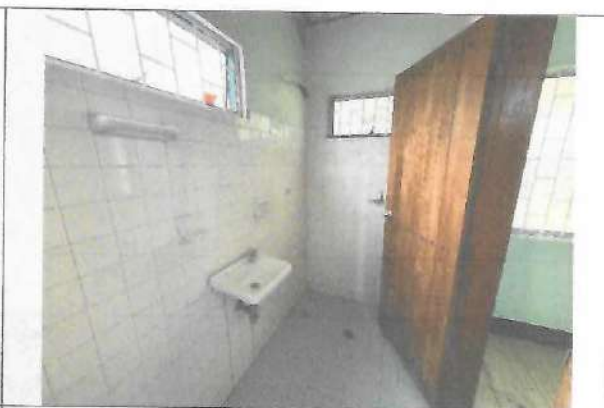
Fotografía No. 14 - Baño consultorio 2
