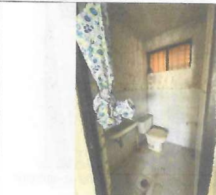
Fotografía No. 18 – Baño consultorio 1
