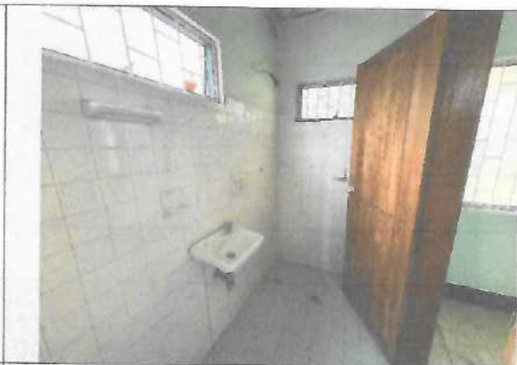
Fotografía No. 14 – Baño consultorio 2
