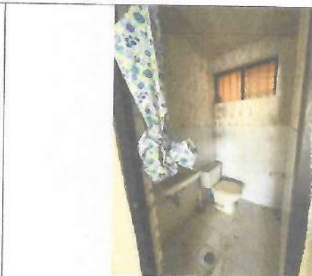
Fotografía No. 18 – Baño consultorio 1
