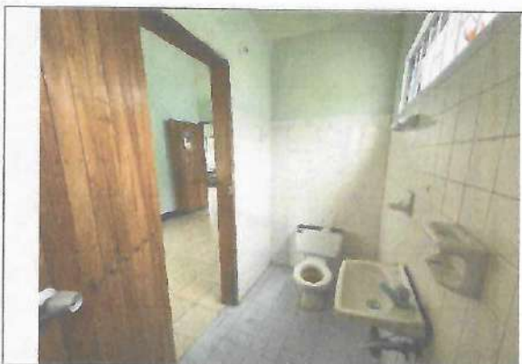
Fotografía No. 15 - Baño consultorio 2
