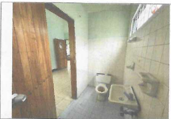
Fotografía No. 15 - Baño consultorio 2
