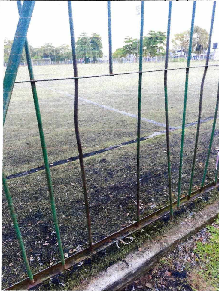
Ilustración 8. Proximidad crítica entre zona de juego y cerramiento posterior
