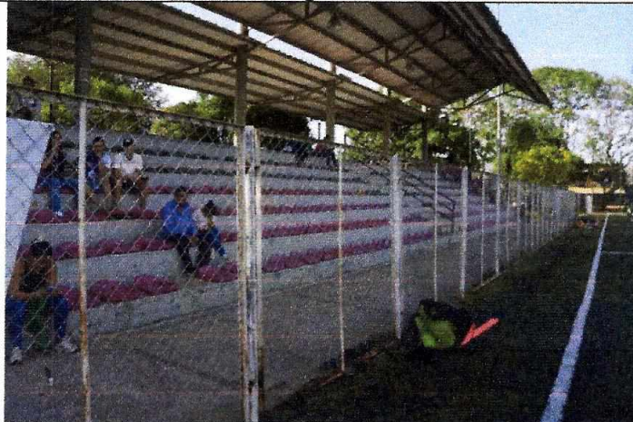
Ilustración 13. Condiciones generales de deterioro funcional.
