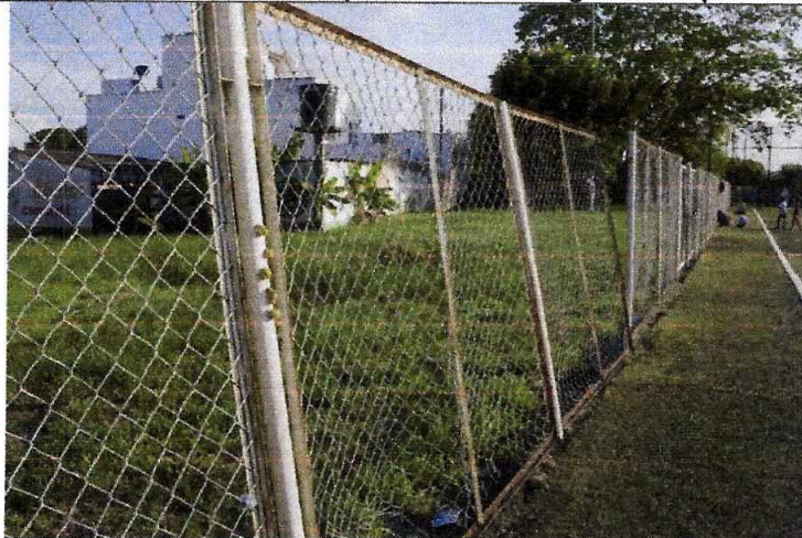
Ilustración 4 Cerramiento perimetral en riesgo de colapso
