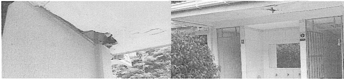
Deterioros en las zonas de circulación exterior del bloque.
