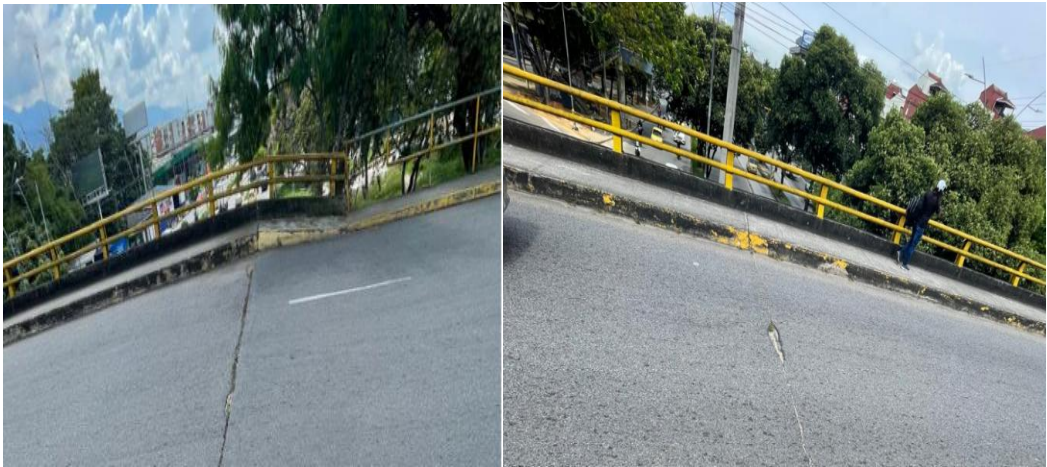
Fotografía 4 y 5 Estado actual de las juntas del puente. (fuente propia).
