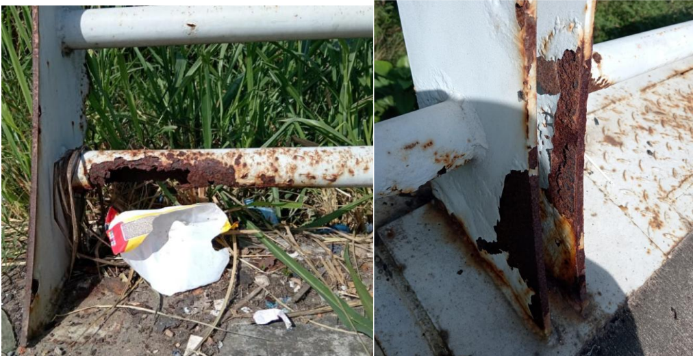
Fotografía 2 y 3 Estado actual de estructura de barandas y tubería (fuente propia)
