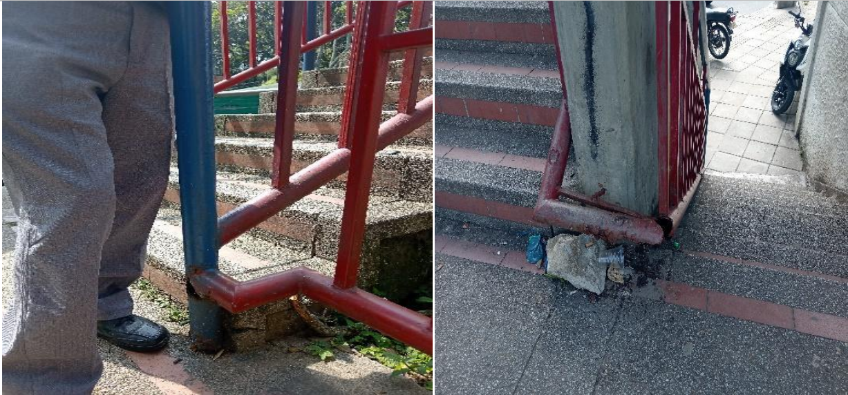
Fotografía 1 y 2 Estado Actual del desgaste y daño de las barandas por la corrosión en le sitio por falta de mantenimiento (fuente propia)
