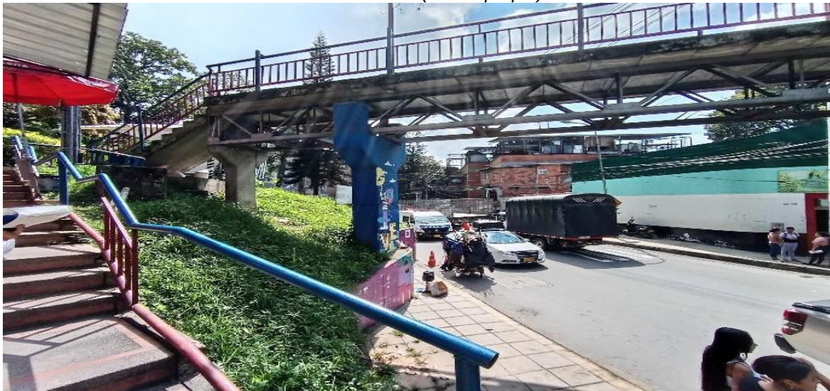
Fotografía 3 Estado de las barandas donde se evidencia perdida de tubería presuntamente por vandalismo. ( Fuente Propia)
