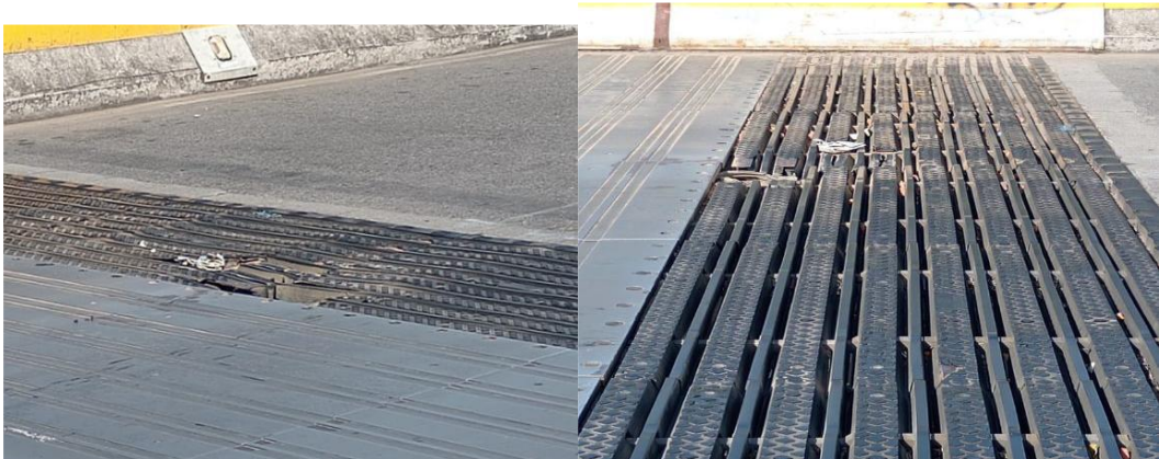
Fotografía 4 Estado actual de las juntas del puente. (fuente propia)
