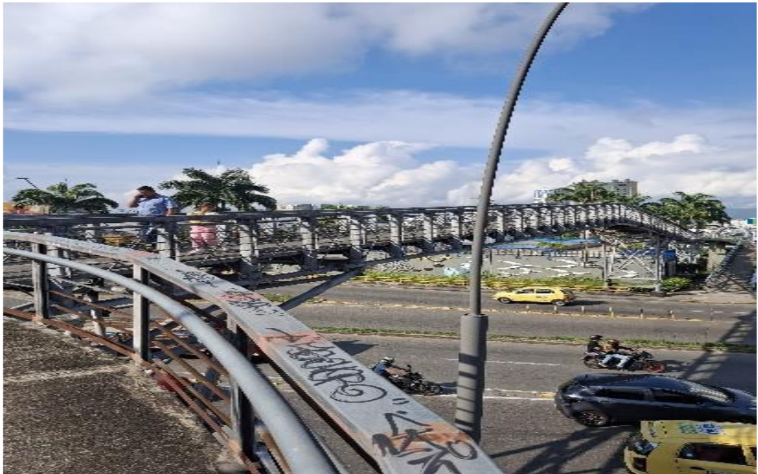
Fotografía 5 estado actual de las barandas y platinas en el sistema de cerchas, donde se evidencia corrosión (fuente propia)
