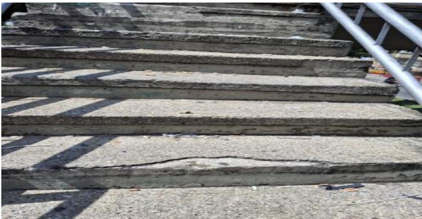
Fotografía 4 Estado actual de las escaleras (fuente propia)
