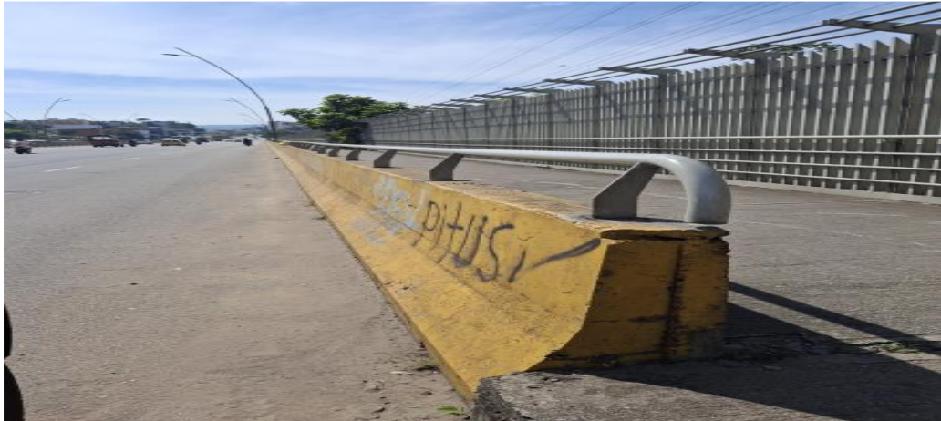
Fotografía 1 Estado actual de aislamiento de la zona peatonal del puente de la vía de transito (fuente propia)
