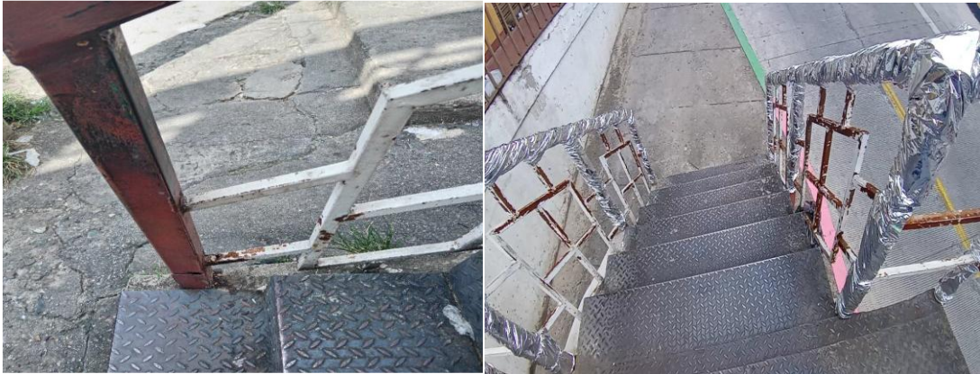
Fotografía 2 y 3 Estado actual de estructura de barandas y tubería con daños por oxidación, corrosión y perdida de pintura (fuente propia)
