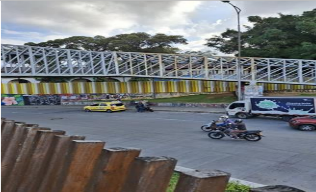
Fotografía 5 Estado actual del costado occidental donde se evidencia el color amarillento producto de la corrosión.
