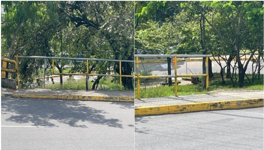
Fotografía 2 y 3 Estado actual de las barandas y tubería. (fuente propia)
