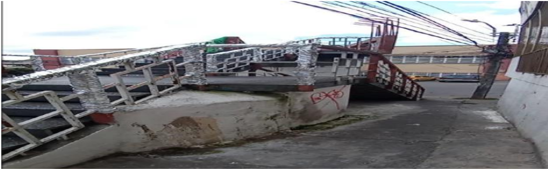
Fotografía 1 Estado actual de los muros (Fuente Propia)
