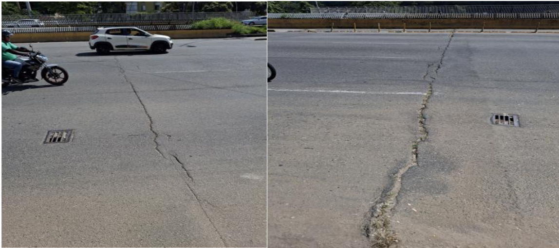
Fotografía 3 y 4 Estado actual de la calzada. (fuente propia)
