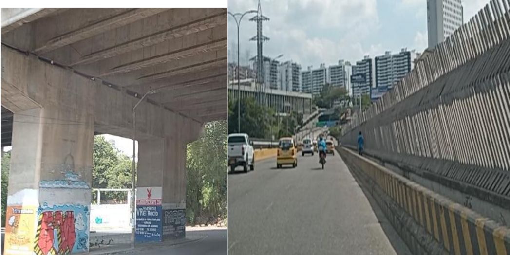
Fotografía 2 Estado actual de la pintura en los muros y columnas en concreto (fuente propia)
