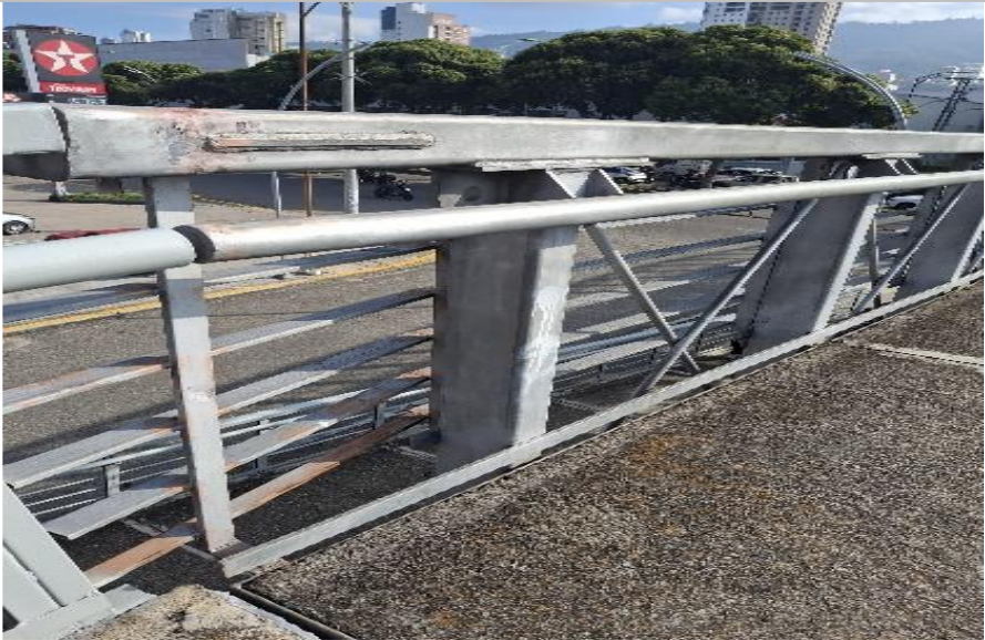
Fotografía 2 evidencia aspecto amarillento producto de la corrosión ( fuente propia)
