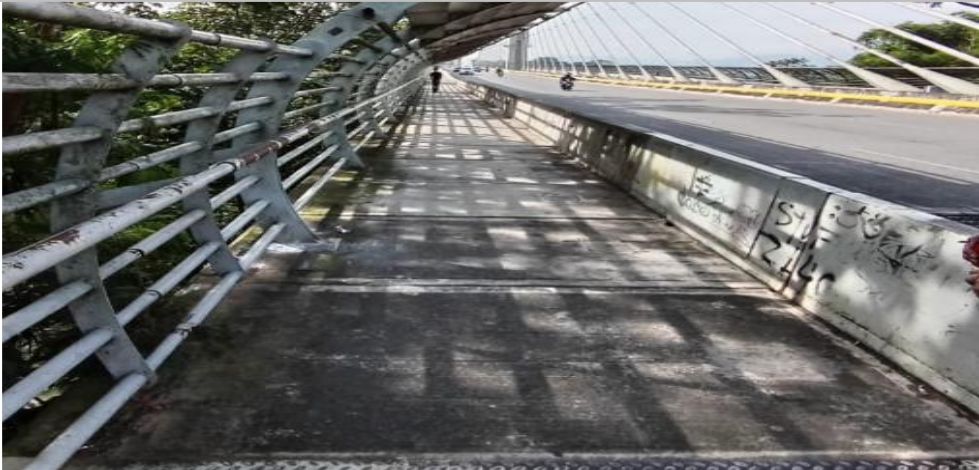
Fotografía 1 Estado actual de la superficie y baranda del puente. (fuente propia)
