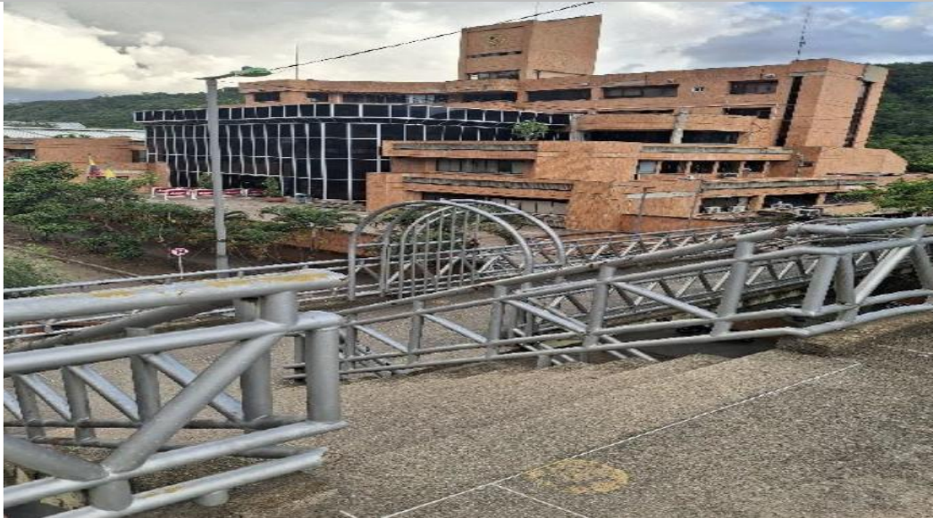
Fotografía 4 evidencia estado actual de baranda deteriorada por corrosión. (fuente propia)
