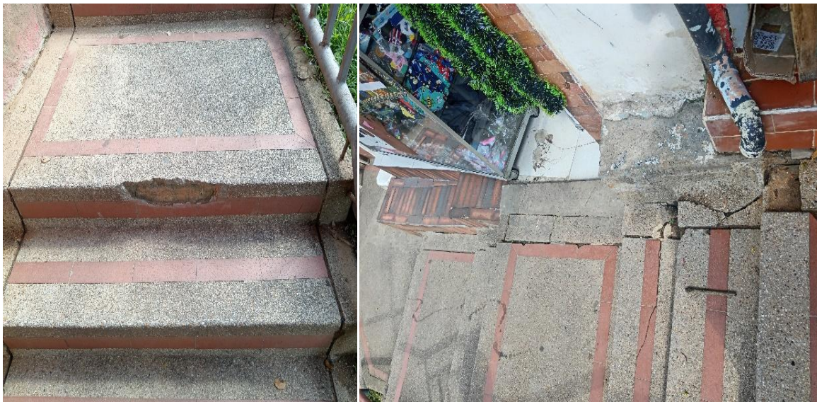
Fotografía 4 y 5 Estado actual del granito que compone las escaleras del puente peatonal. (fuente propia)
