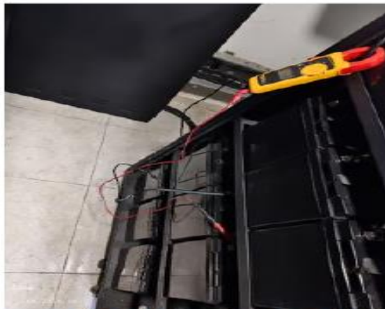
Verificación de baterías | Placa fecha
