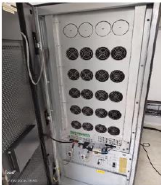
Equipo destapado | Después del servicio
