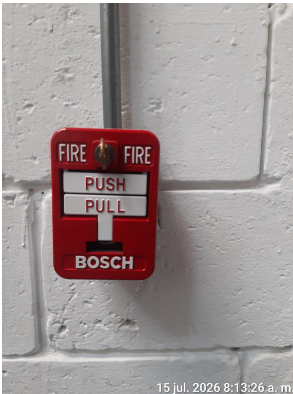
Foto 21. Verificación de los sistemas de seguridad (alarma contra incendio), en cumplimiento de la obligación 15 del contrato.
