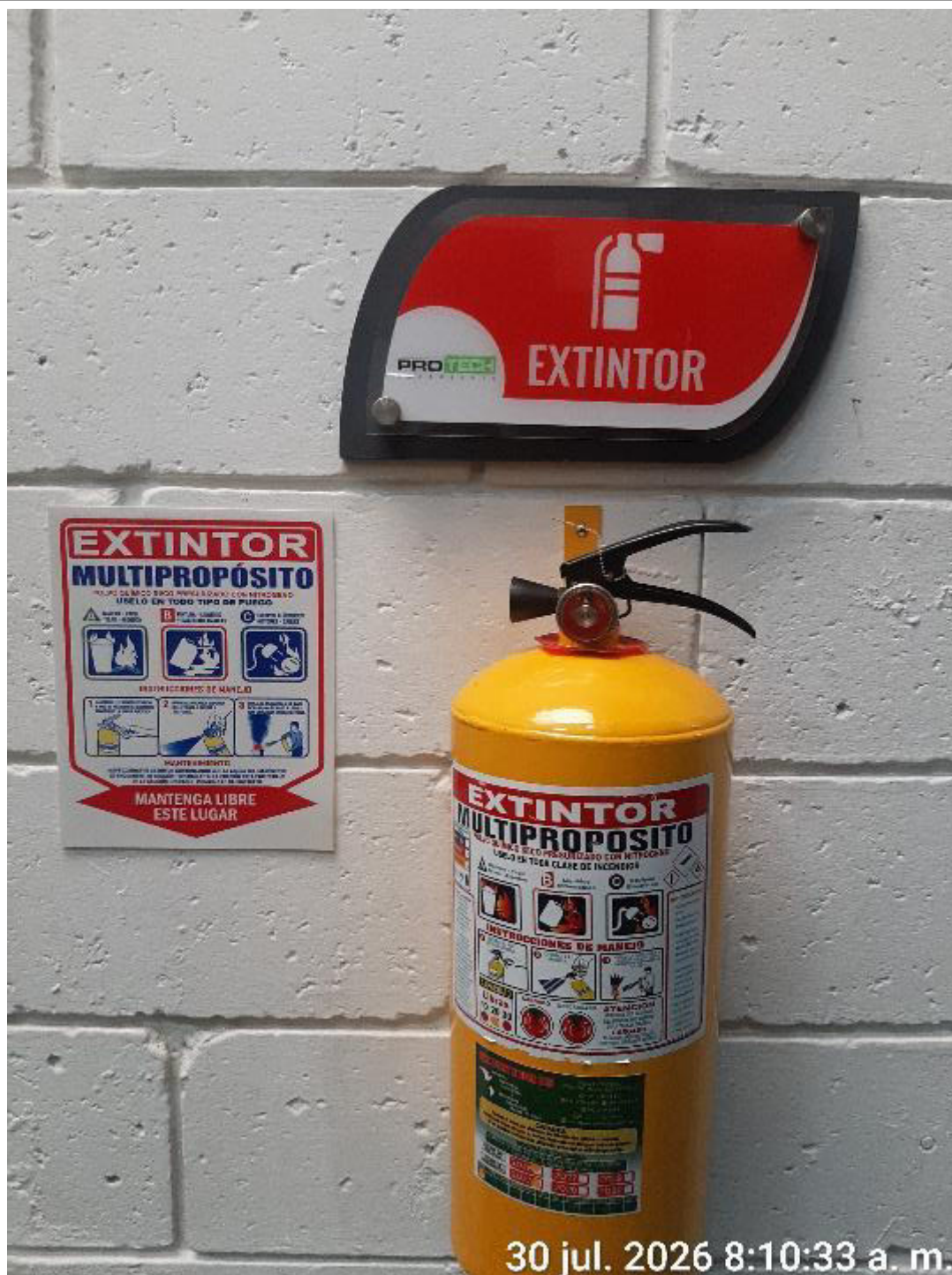
Foto 15. Verificación de los sistemas de seguridad (extintor), en cumplimiento de la obligación 15 del contrato.
