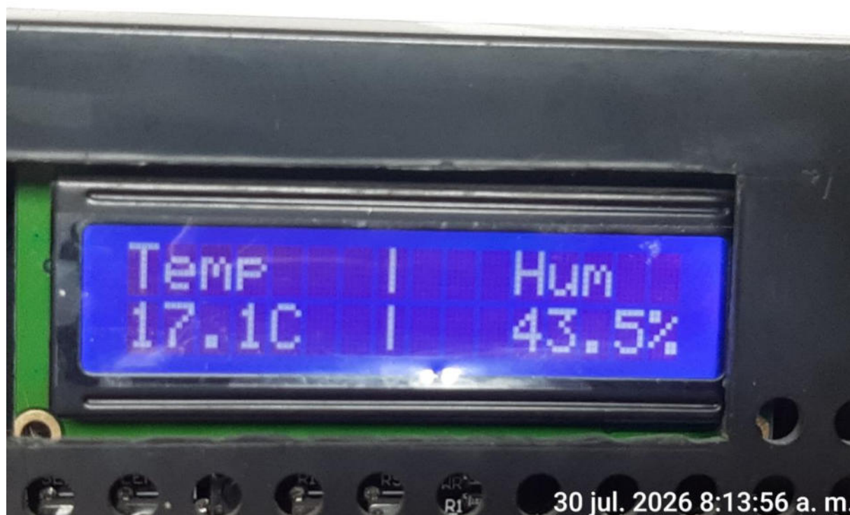
Foto 12. Detalle de lectura de humedad relativa de 43.5% y temperatura de 17.1°C para soporte medio óptico durante la visita del 30 de julio de 2026, la cual está de conformidad con lo estipulado en el numeral 4.2. del Anexo del contrato.
