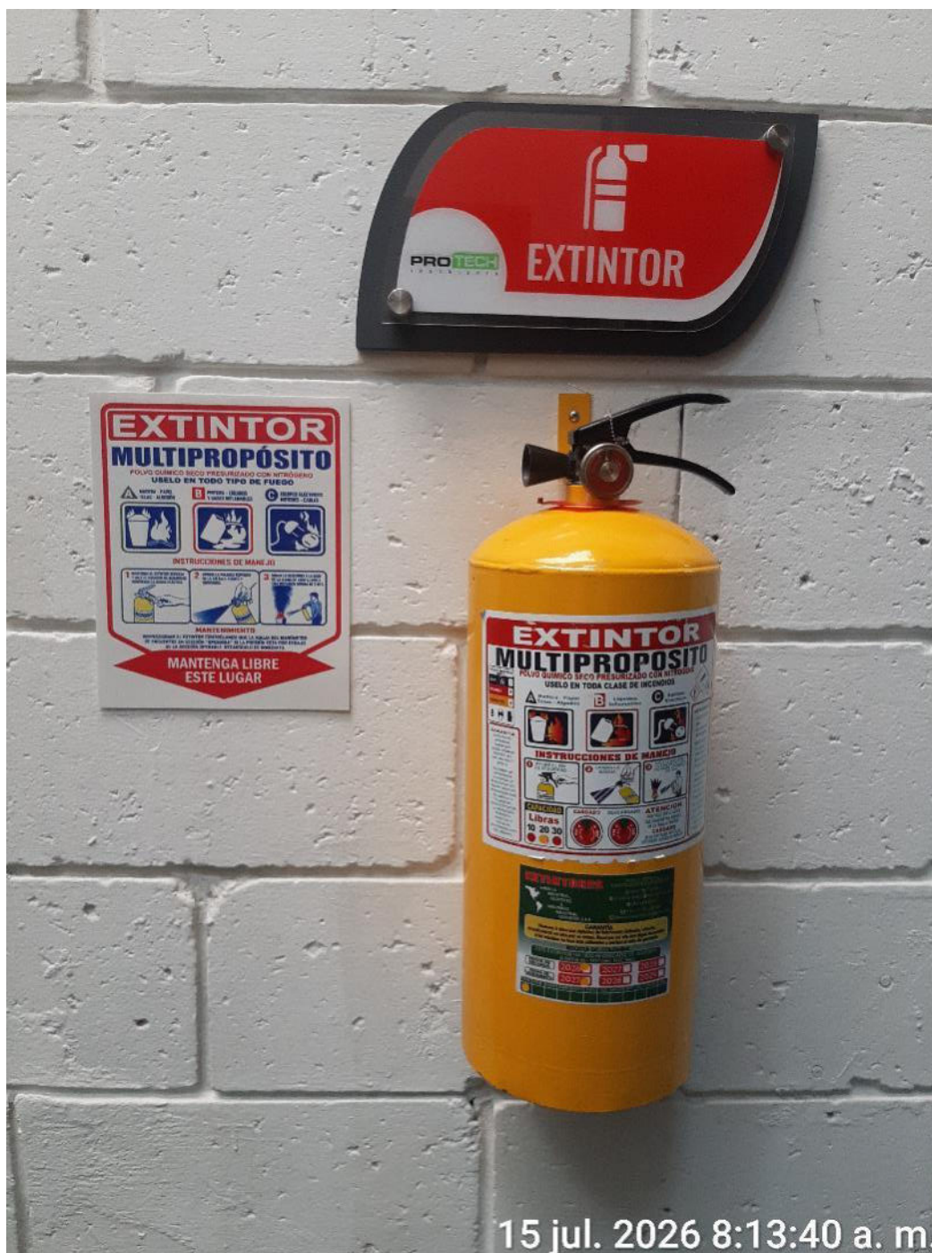
Foto 19. Verificación de los sistemas de seguridad (extintor) en cumplimiento de la obligación 15 del contrato.
