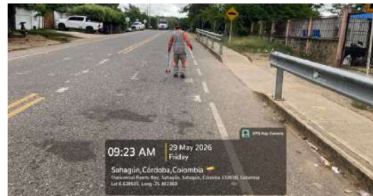
Identificación de puntos para sellado de fisuras - Loricá - Chinú
