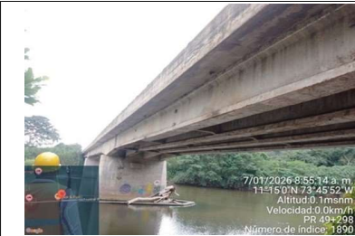
Diagnostico de estructura del Puente Buritaca - PR49+298 (RN9008)
