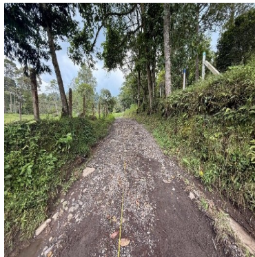
Punto intermedio K7+591 74^{\circ}14'30.96''\text{O} 5^{\circ}0'7.87''\text{N} , no tiene manejo de agua lluvia, desgaste en la carretera mal afirmado
