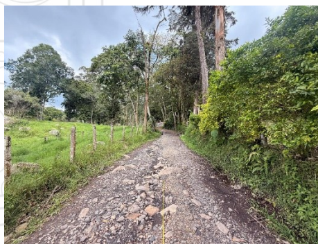
Punto Final K2+721 74^{\circ}16'19.75''W 4^{\circ}59'26.41''N Final sobrante del recebo presenta mal afirmado y compactado en varias zonas.
