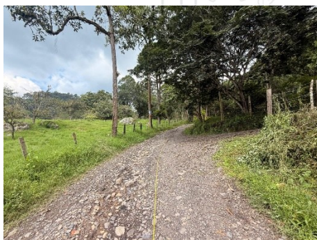
Punto intermedio K2+696 74^{\circ}16'20.28''O 4^{\circ}59'25.80''N , no tiene manejo de agua lluvia, desgaste en la carretera mal afirmado.
