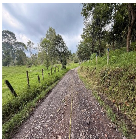
Punto Final K7+636 74^{\circ}14'30.12''\text{W} 5^{\circ}0'9.01''\text{N} Final sobrante del recebo presenta mal afirmado y compactado en varias zonas..
