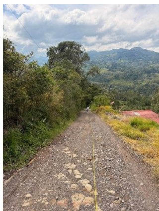
Punto inicial K7+511 ( 74^{\circ}14'32.04''\text{W} 5^{\circ}0'6.57''\text{N} ) Tramo sin obras de drenaje, con una pendiente aproximada de 5.5%.
