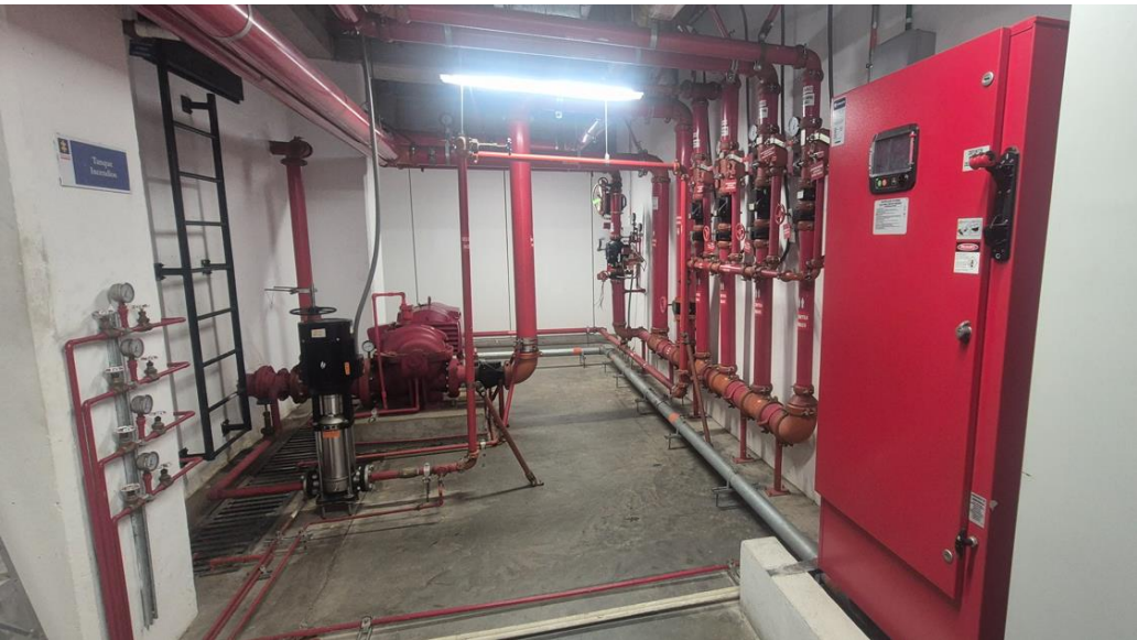
Equipos principales que componen el sistema
