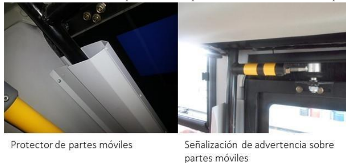
Ilustración 96: Elementos de protección de piezas móviles del sistema de puertas
