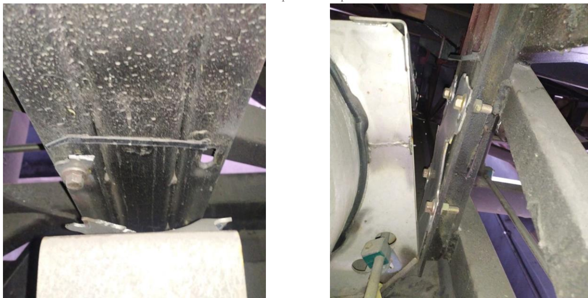
Ilustración 34: Falla de diseño en soporte de tanques de combustible
