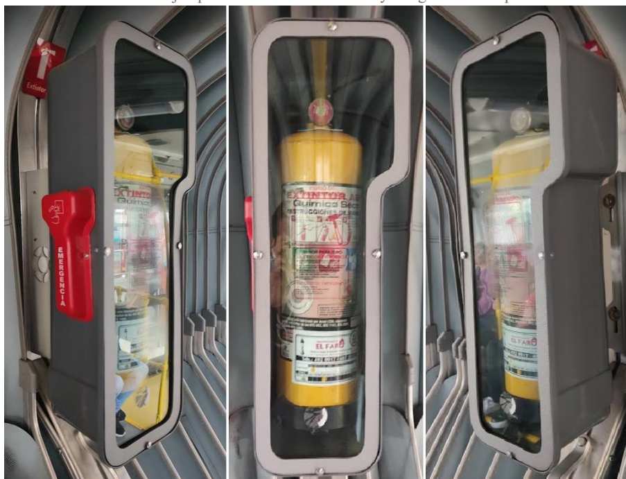
Ilustración 79: Ejemplo de extintores de cabina y sus gabinetes de protección
