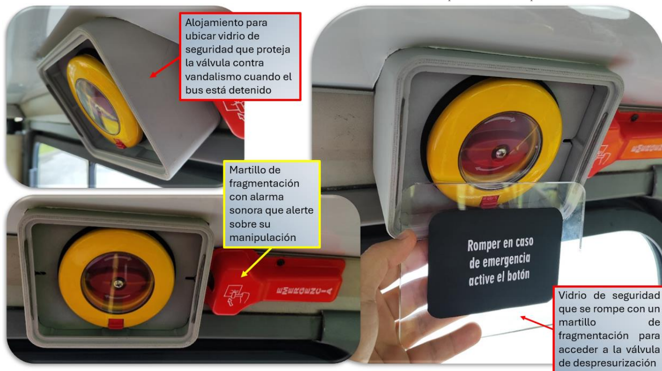
Ilustración 78: Protección adicional contra vandalismo - válvulas de despresurización de puertas.
