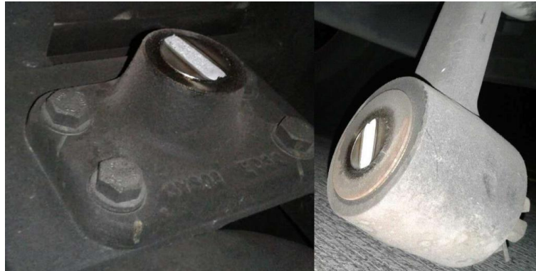
Ilustración 37: Fractura en soporte de brazo Pittman de vehículo con menos de 20.000 km recorridos.
